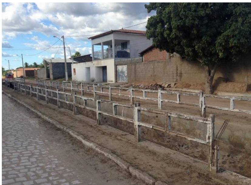
Figura 30: Proteção de todo o canal fragmentado e com destacamento
