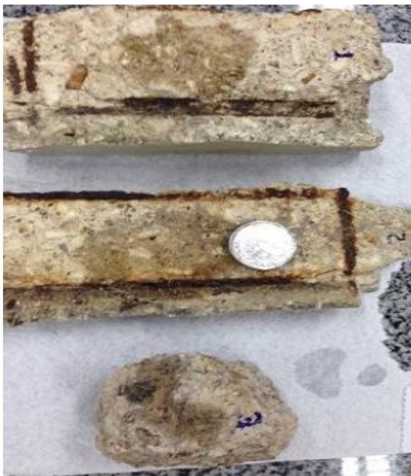
Figura 34: Presença de carbonatação.
