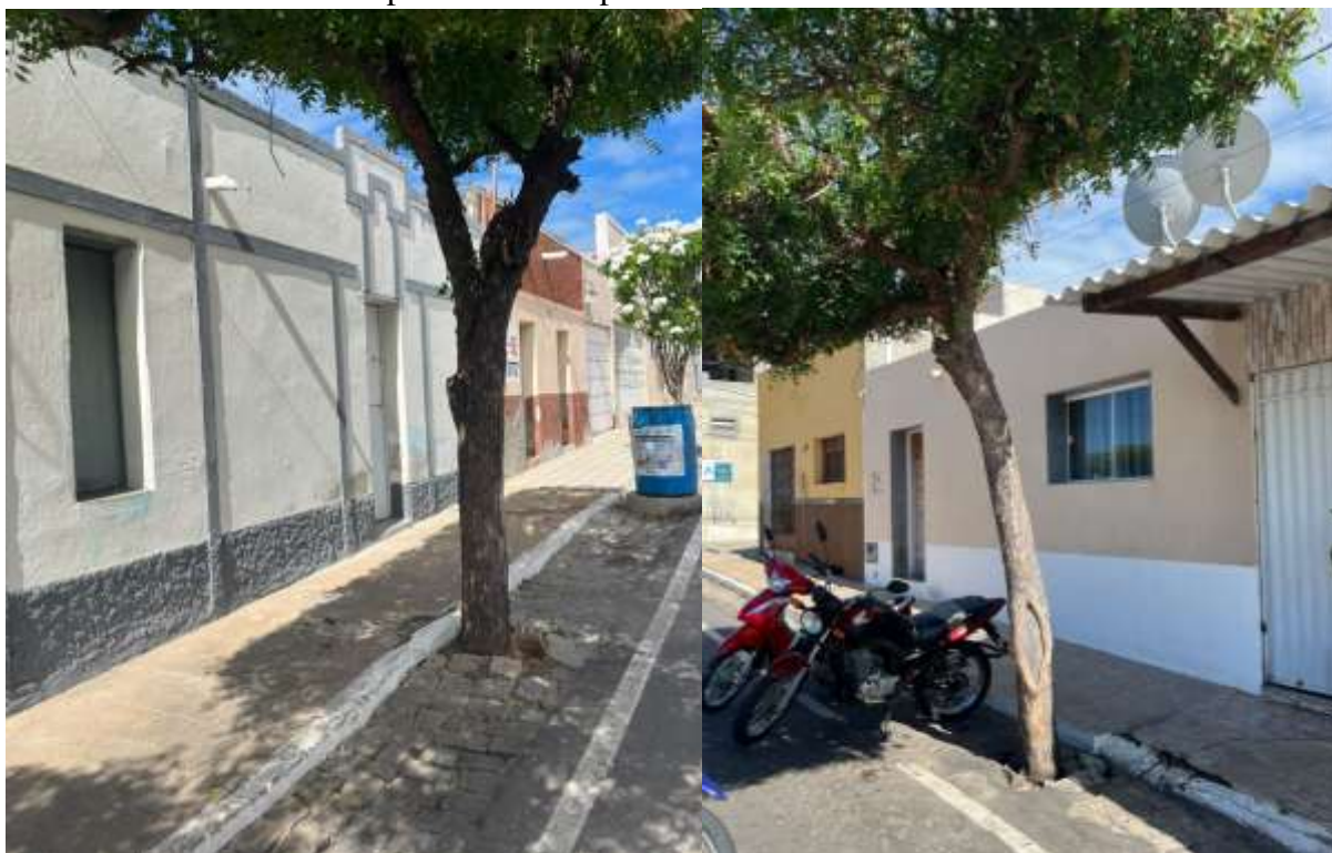
Figura 1 – Danos estruturais em calçadas públicas ocasionados pelo crescimento de sistemas radiculares superficiais de espécies exóticas em Riacho da Cruz/RN
