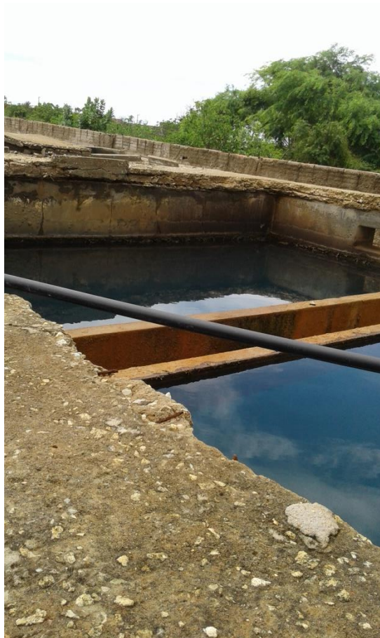
Figura 4 – Reservatório do sistema de abastecimento de água
