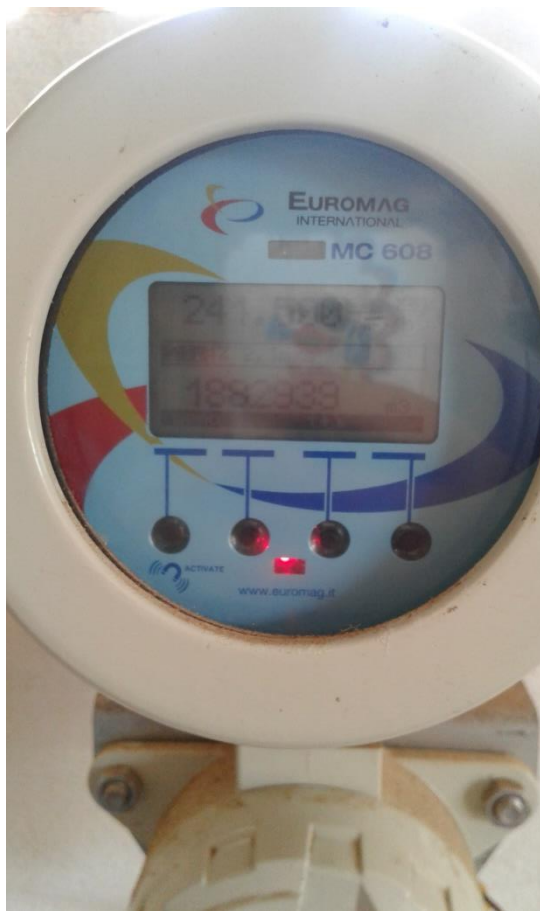
Figura 8 – Medidor de vazão utilizado no sistema de abastecimento de água
