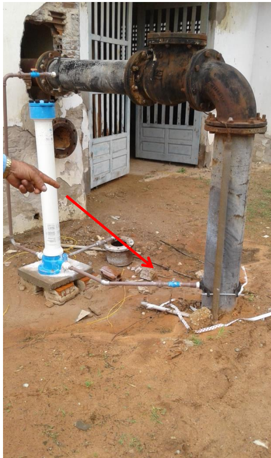
Figura 6 – Cano de tratamento com cloro
