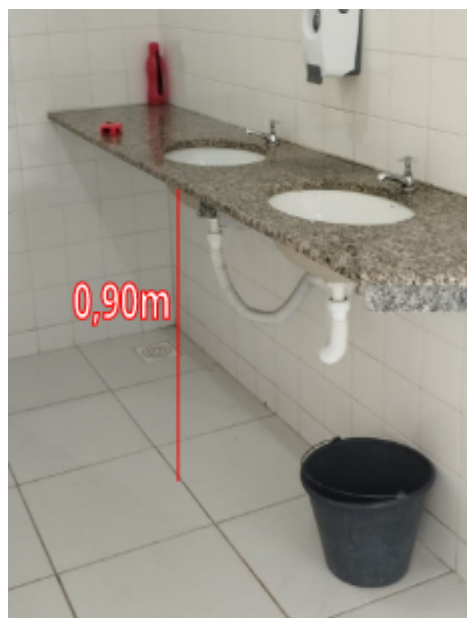
Figura 17: Lavatório banheiro Masc.
