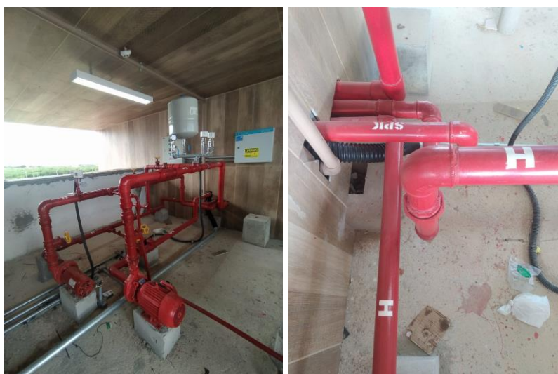
Figura 28 - Conjunto bomba de incêndio, sinalização da tubulação, quadro de comando e manômetro do sistema de hidrantes.
