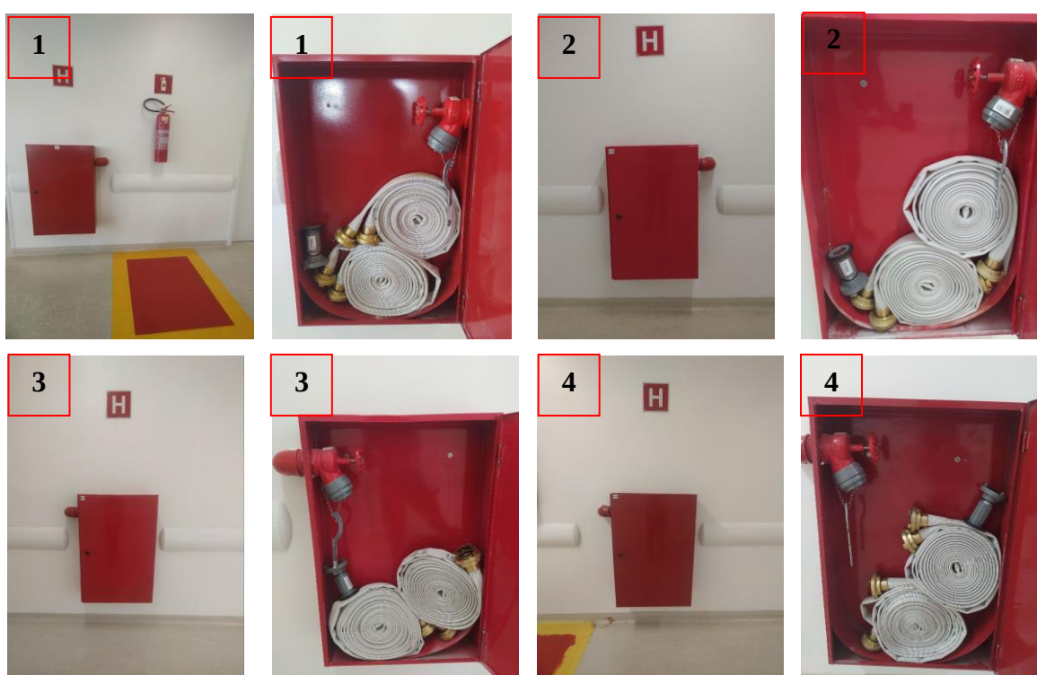
Figura 25 - Hidrantes do pavimento ambulatorial
