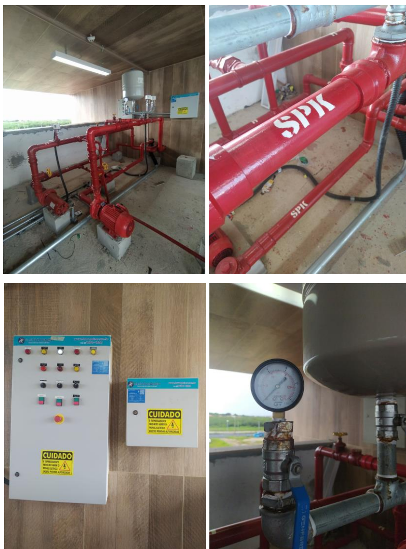
Figura 31 - Conjunto bomba de incêndio, sinalização da tubulação, quadro de comando e manômetro do sistema de hidrantes.
