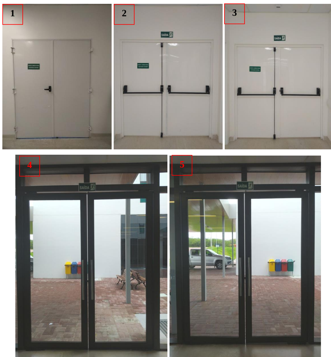
Figura 13 - Portas corta-fogo e portas principais de acesso do pavimento ambulatorial
