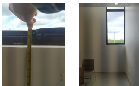
Figura 10 - Distância entre caixilhos do pavimento ambulatorial ao pavimento inferior
