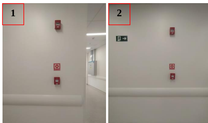
Figura 16 - Acionadores manuais e avisadores áudio visuais do pavimento ambulatorial
