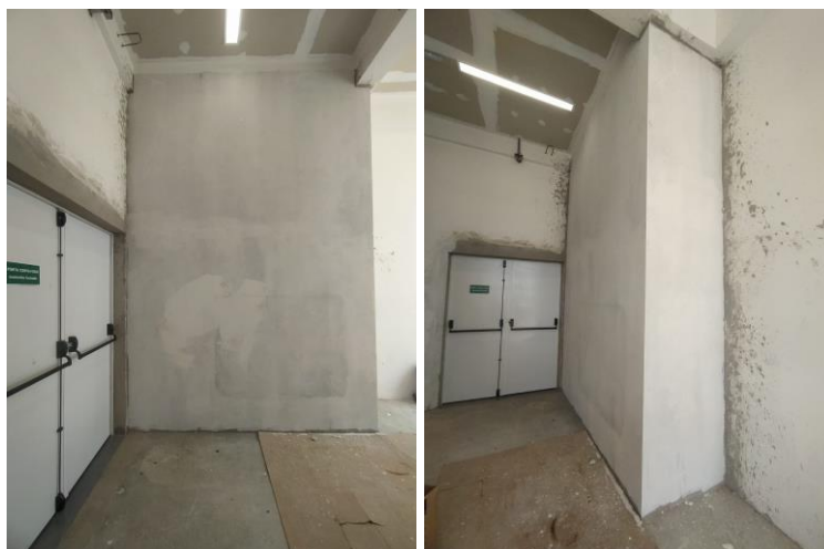
Figura 19 - Ausência de sinalização do tipo S17 e de continuidade da rota de fuga
