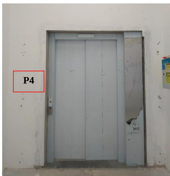
Figura 22 - Ausência de sinalização de proibição no elevador
