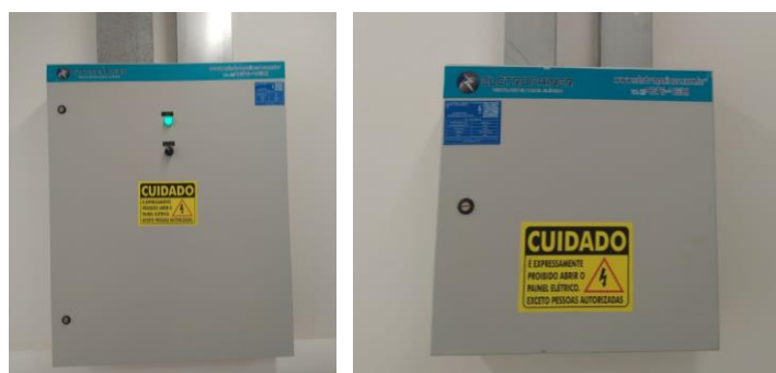
Figura 20 - Sinalização de alerta presentes nos quadros elétricos
