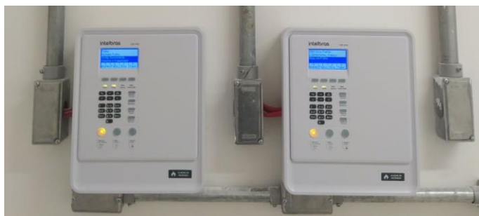
Figura 17 - Central de alarme do pavimento ambulatorial na sala de monitoramento
