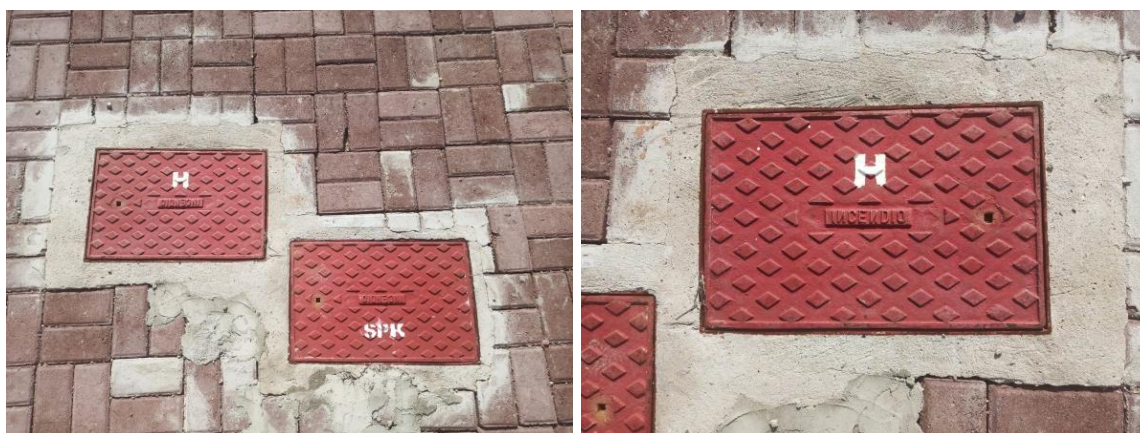
Figura 29 - Hidrantes de recalque do sistema de hidrantes do bloco D
