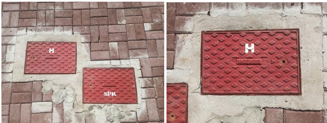
Figura 32 - Hidrantes de recalque do sistema de chuveiros automáticos do bloco D
