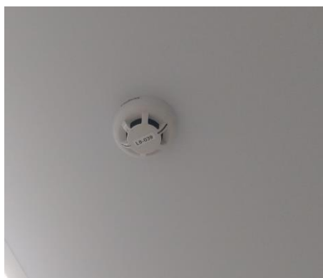
Figura 15 - Detector de fumaça óptico do pavimento ambulatorial
