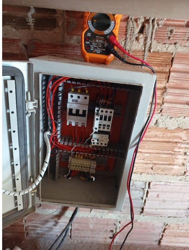
Figura 13- Quadro de comando da bomba de recalque.
