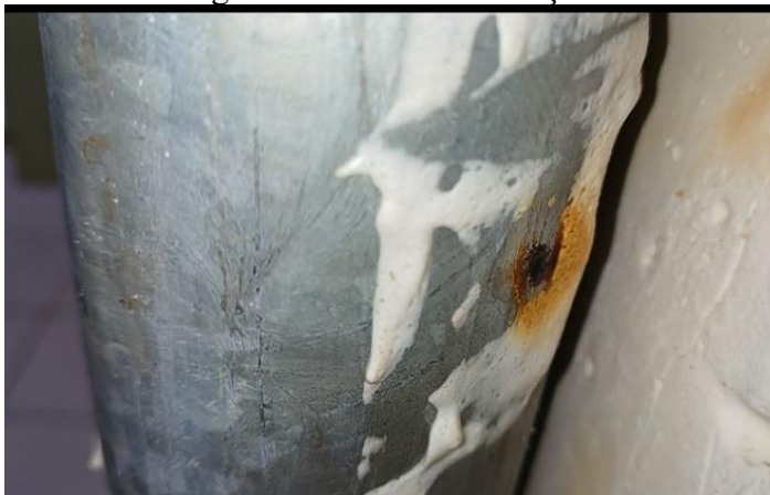
Figura 27- Furo na tubulação.
