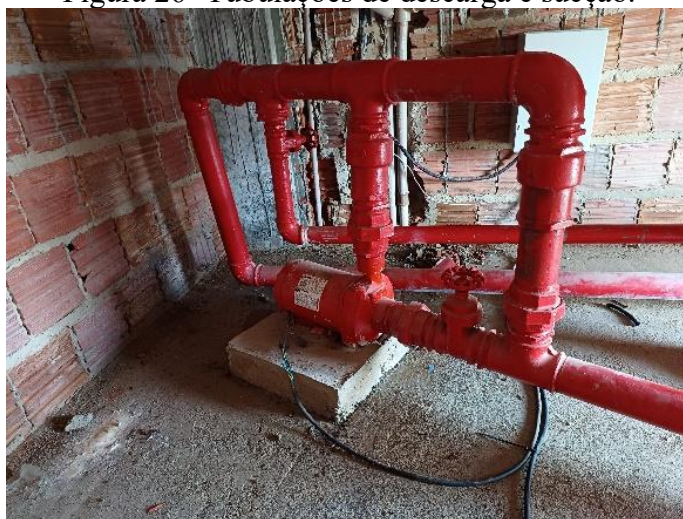
Figura 26- Tubulações de descarga e sucção.
