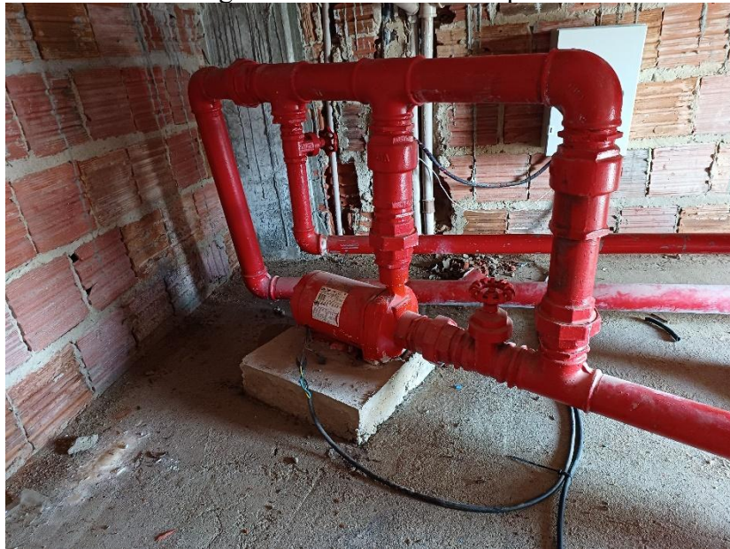
Figura 12- Bomba de recalque.
