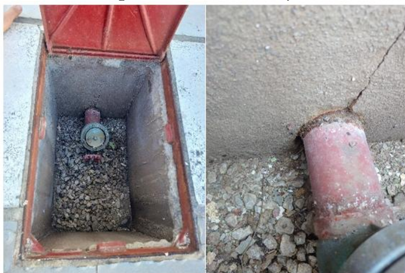
Figura 24- Hidrante de recalque.
