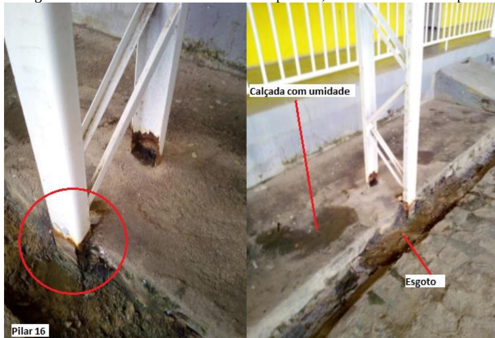
Figura 27 – Caso de corrosão uniforme no pilar 16, e o meio onde está exposto
