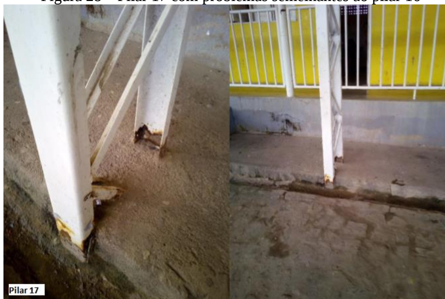
Figura 28 – Pilar 17 com problemas semelhantes ao pilar 16
