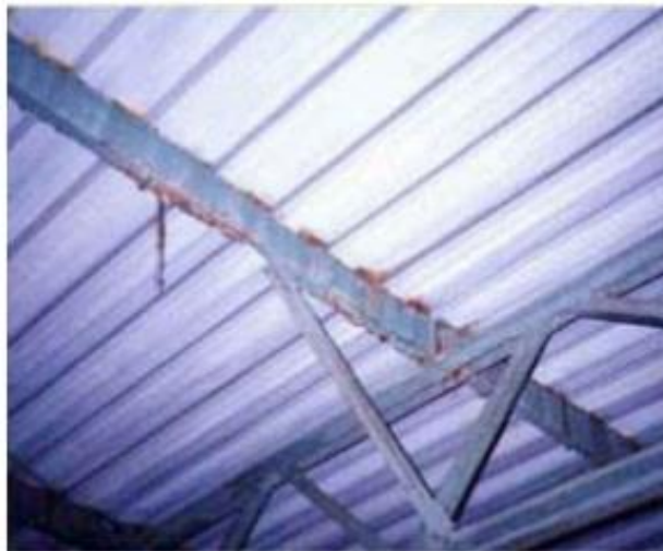
Figura 5 – Corrosão em Asna devido o contato de chapas galvanizadas ou de alumínio com o aço
