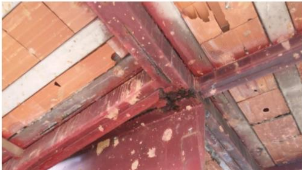
Figura 33 – Frestas na estrutura da ponte Sebastião Carlota
