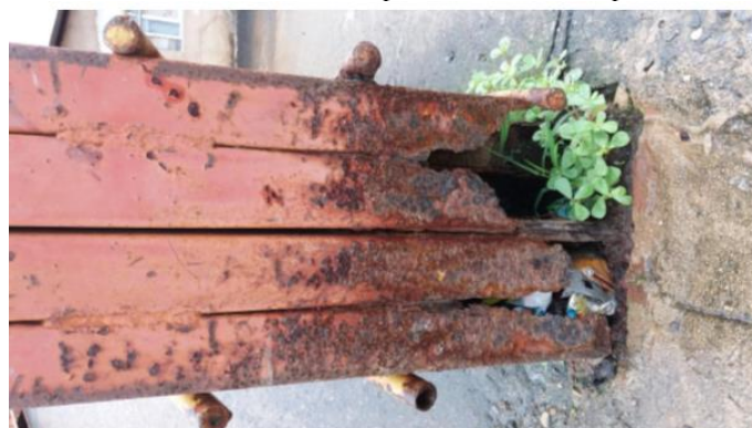
Figura 35 – trecho com corrosão por ranhuras na passarela Sebastião Carlota
