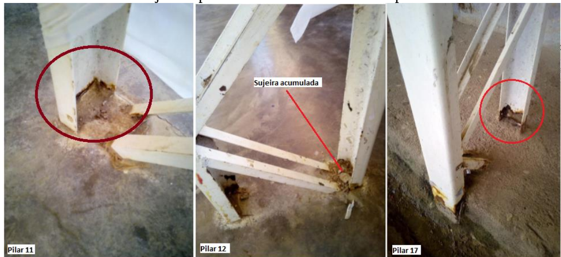
Figura 31 – Pilar 11 com corrosão aparecendo depois de retirado a sujeira, pilar 12 com acúmulo de sujeira e pilar 17 com Alma consumida pela corrosão
