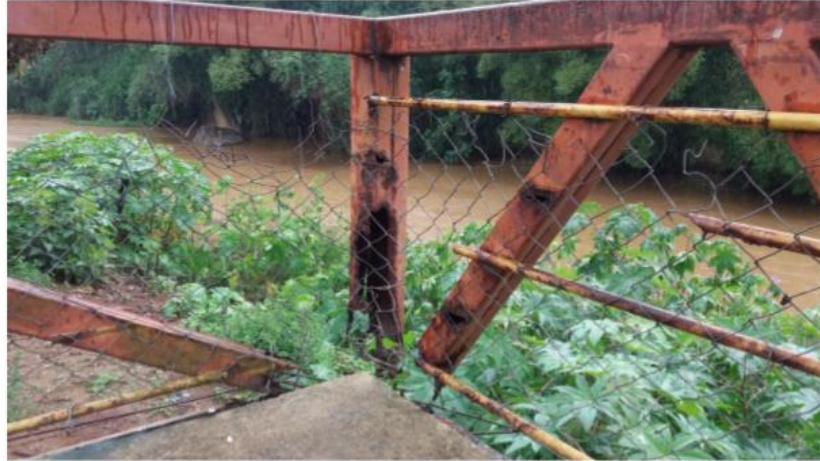
Figura 29 – perfis metálicos da Passarela Sebastião Carlota danificados e com perda de área da seção transversal devido a corrosão
