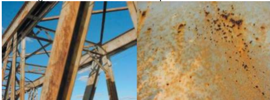
Figura 30 – Corrosão uniforme na ponte Marechal Hermes
