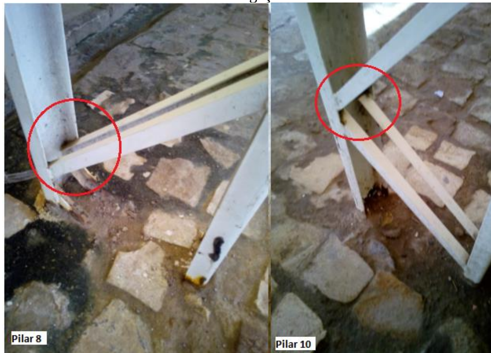
Figura 31 – Pilar 8 com acúmulo de sujeira na ligação soldada, e pilar 10 com corrosão na ligação
