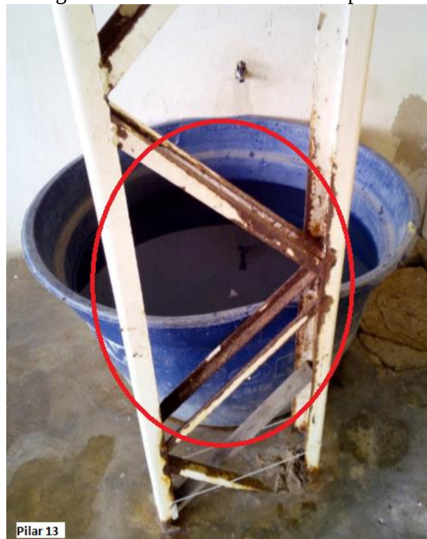
Figura 25 – Corrosão uniforme no pilar 13
