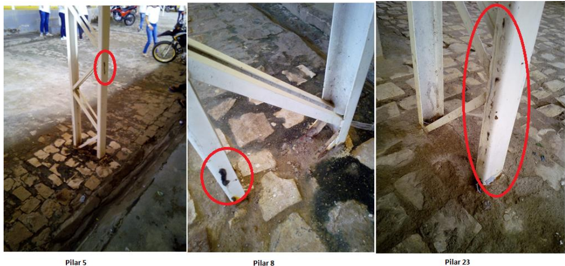
Figura 23 - Exemplos de arranhões e descascamentos ilustrados em alguns pilares da estrutura
