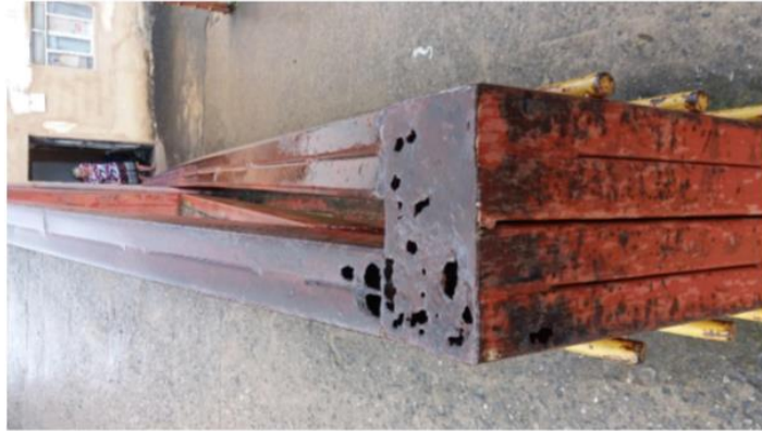
Figura 4 – Corrosão por pites em estrutura metálica
