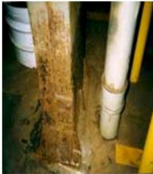
Figura 2 - Corrosão uniforme em uma coluna metálica
