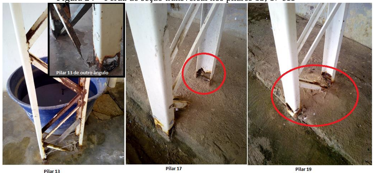
Figura 24 – Perda de seção transversal nos pilares 13, 17 e 19
