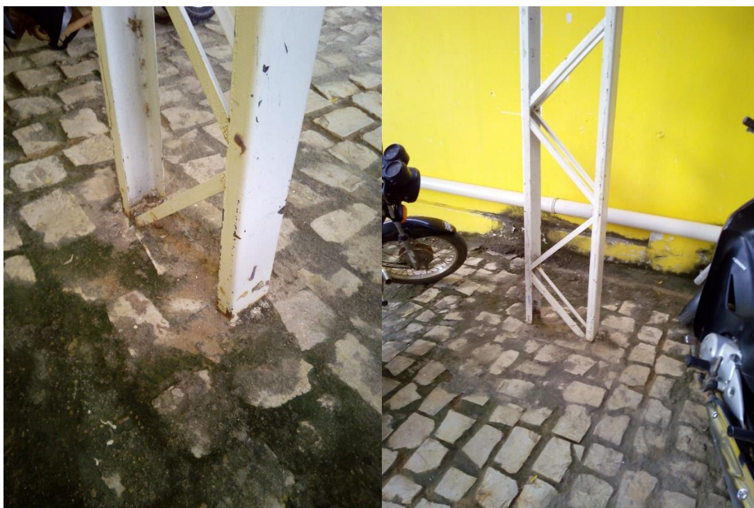
PILAR 24 Z24 = 3 CM APROXIMADAMENTE ( CORROSÃO LEVE SOBRE A TINTA NÃO COMPROMETENDO O DESEMPENHO DA ESTRUTURA)
