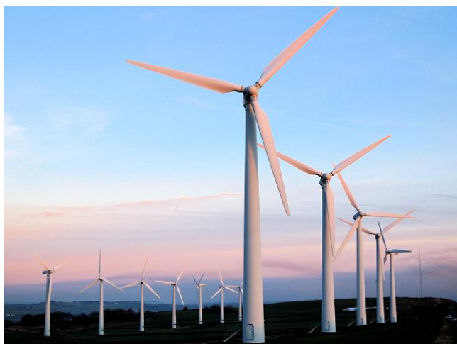
Figura 13 - Aerogerador de 3 pás.
