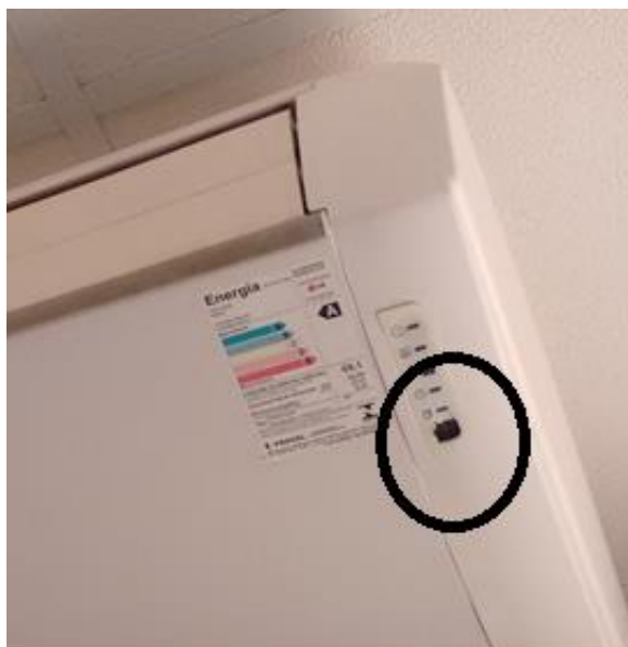
Figura 10 - Ar condicionado Sala 01.
