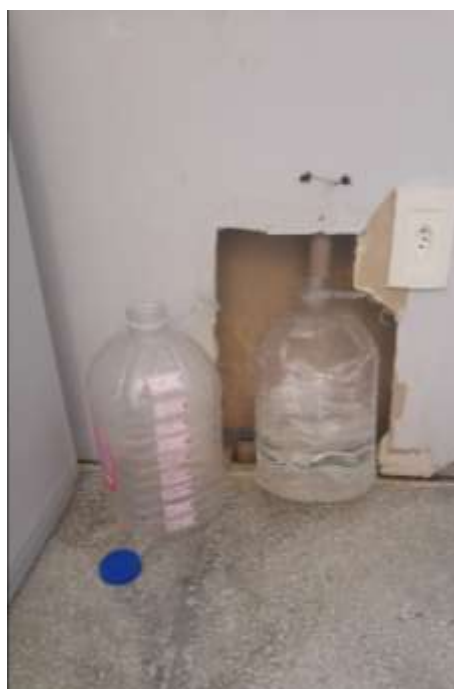
Figura 14 - Medição do bloco administrativo (dreno na sala dos terceirizados)
