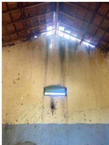
Figura 49 – Telhas faltantes na estação
