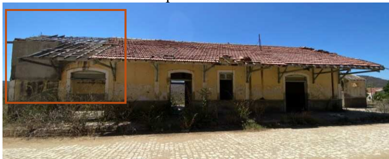
Figura 48 – Desabamento de parte da cobertura e alvenaria da estação
