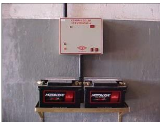
Figura 8 - Sistema centralizado com baterias
