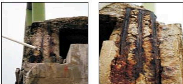
Figura 10 - Corrosão em concreto armado
