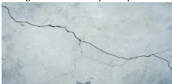
Figura 4 - Rachadura típica em paredes
