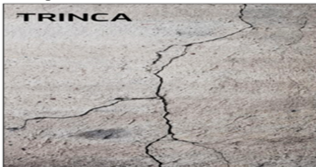
Figura 3 - Trinca estrutural em alvenaria
