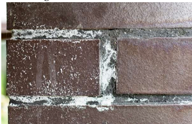
Figura 8 - Eflorescência em fachada
