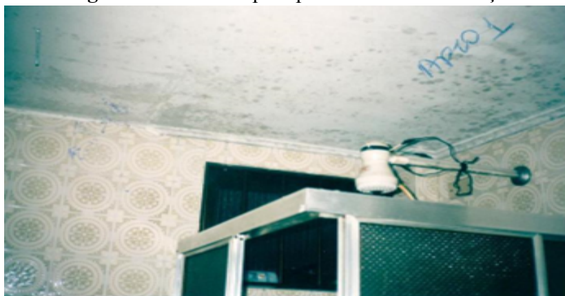
Figura 9 - Umidade pelo processo de condensação
