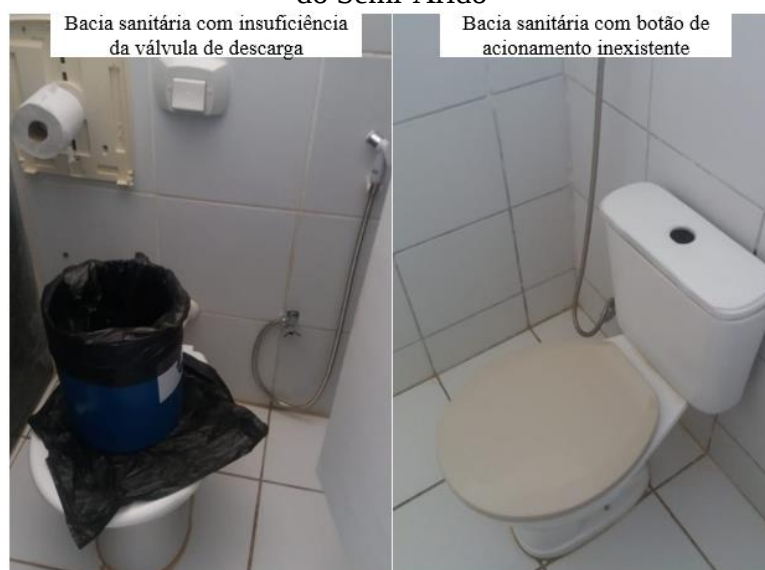
Figura 30 - Bacias sanitárias quebradas nas centrais de aulas da Universidade Federal Rural do Semi-Árido
