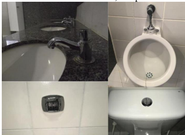
Figura 41 - Equipamentos poupadores de água instalados em edificações da Universidade Federal Rural do Semi-Árido, campus Mossoró
