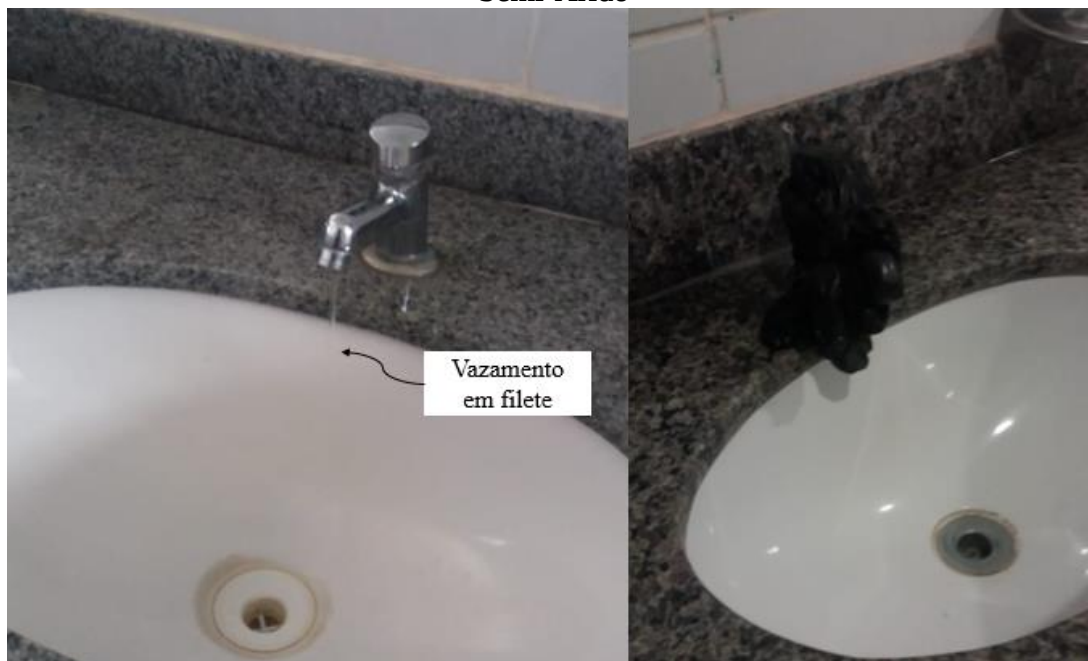
Figura 32 - Torneiras com vazamento nas centrais de aulas da Universidade Federal Rural do Semi-Árido
