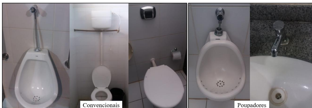
Figura 40 - Aparelhos hidrossanitários convencionais e poupadores de água identificados nas centrais de aulas da Universidade Federal Rural do Semi-Árido
