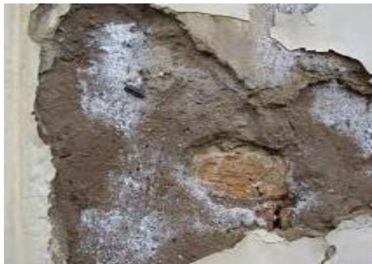
Figura 2. Criptoeflorescência em alvenaria.
