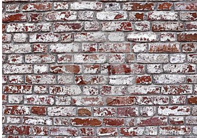
Figura 1. Eflorescência em alvenaria de tijolo.
