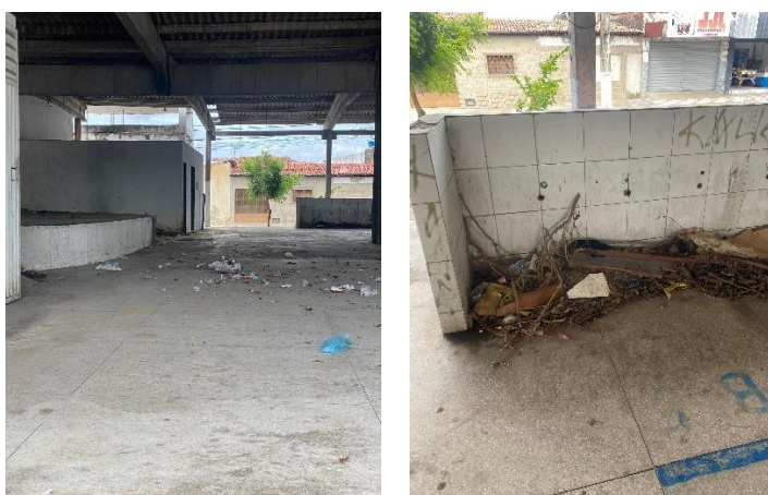
Figura 90: Situação da sujeira dentro do galpão, em 2025
