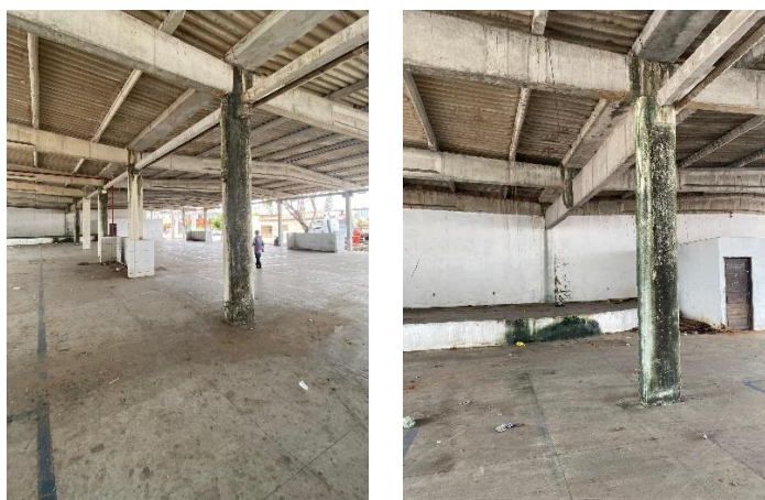
Figura 89: Situação atual dos pilares da estrutura do galpão, em 2025
