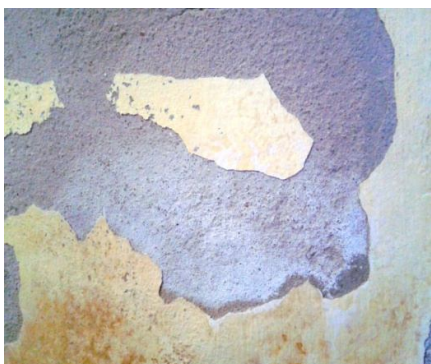
Figura 14 – Depósitos salinos na parede
