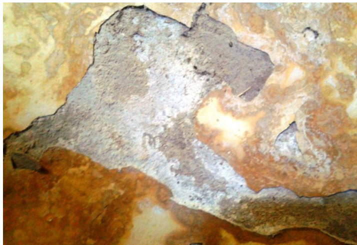
Figura 9 - Degradação na alvenaria – depósitos salinos
