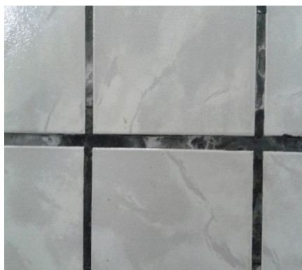
Figura 12 – Depósitos salinos no Rejunte
