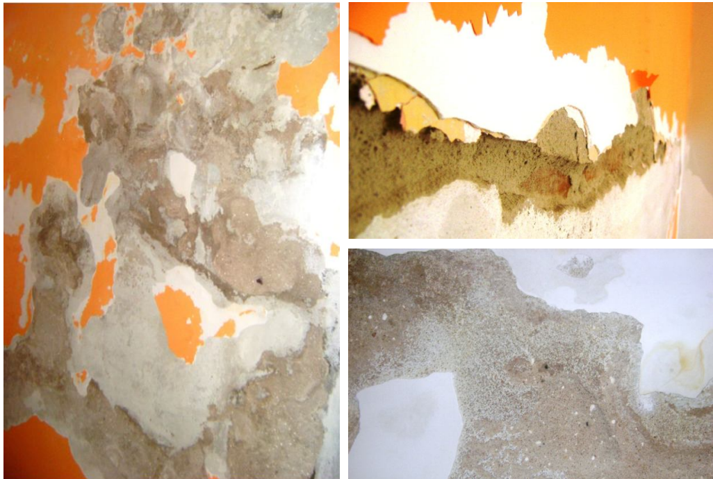
Figura 24 - Danos causados pela umidade e salinidade
