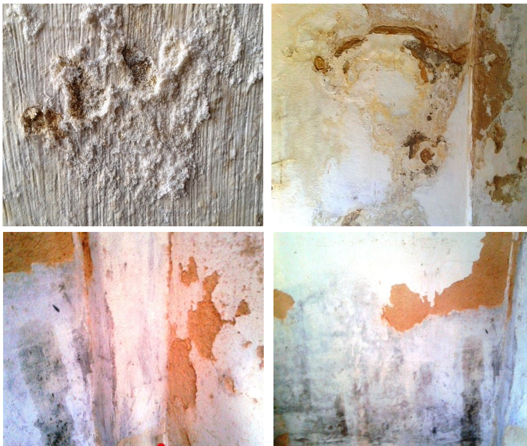
Figura 26 – Umidade e aparecimento de eflorescência nas paredes
