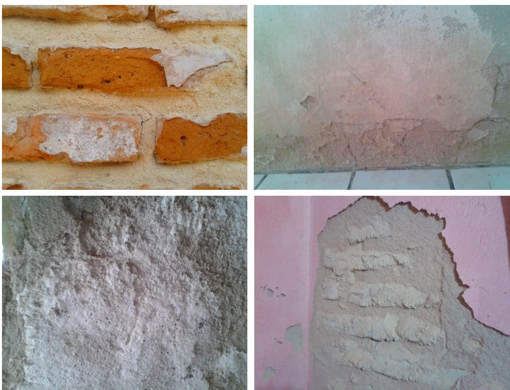
Figura 25 – Degradação da alvenaria, depósitos salinos
