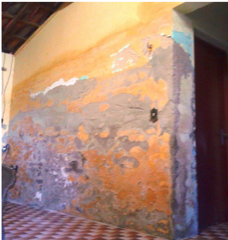
Figura 10 - Danos causados pela eflorescência.
