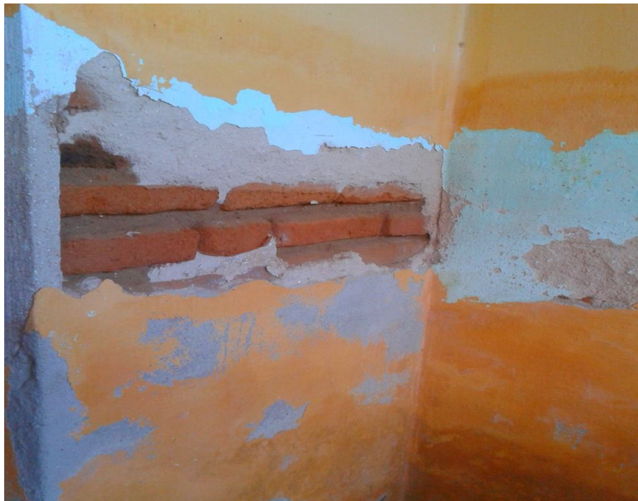
Figura 11 - Degradação da alvenaria
