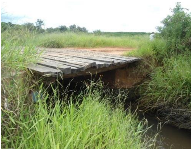
Figura 4. Ponte inviável para passagem de veículo pesado
