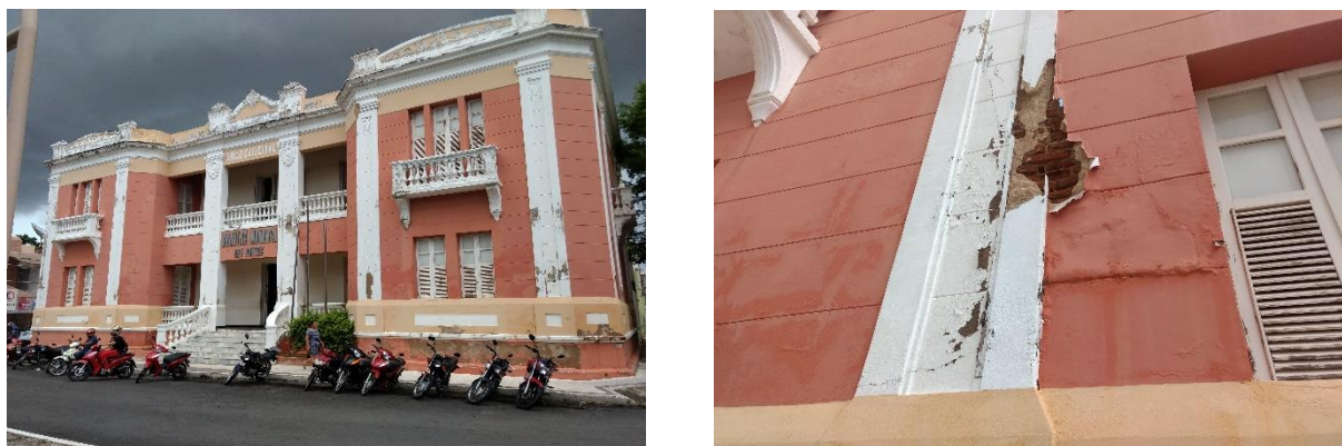
Figura 1. Vista principal da Biblioteca Municipal (A). Estrutura de alvenaria original exposta (B).
