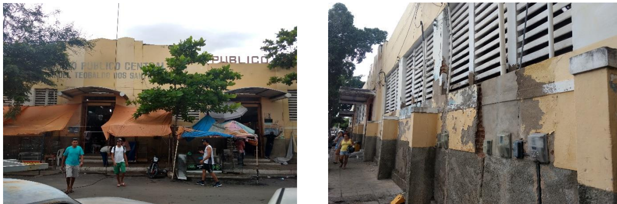
Figura 4. Fachada do Mercado Público Central (A). Danificação nas estruturas (B).
