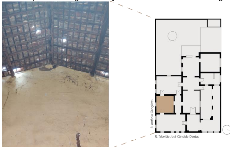
Figura 58 - Telhado apresentando goteiras, sujeira e com o madeiramento desgastado.
