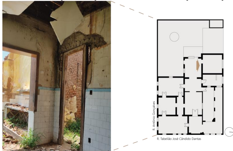
Figura 53 - Deslocamento da esquadria do plano da alvenaria e fissuras por toda superfície da parede.
