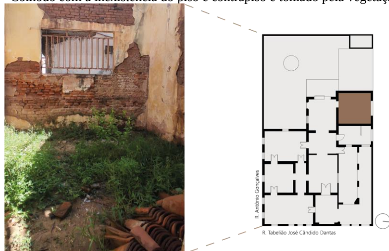
Figura 70 - Cômodo com a inexistência do piso e contrapiso e tomado pela vegetação.
