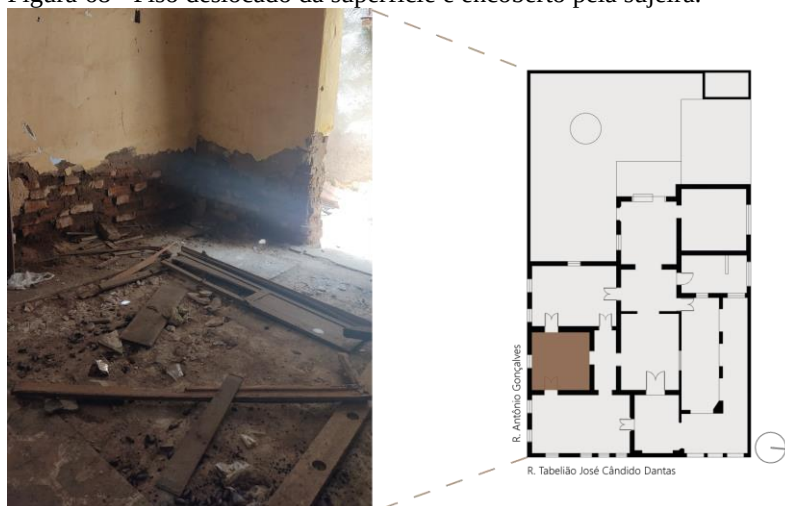
Figura 68 - Piso deslocado da superfície e encoberto pela sujeira.
