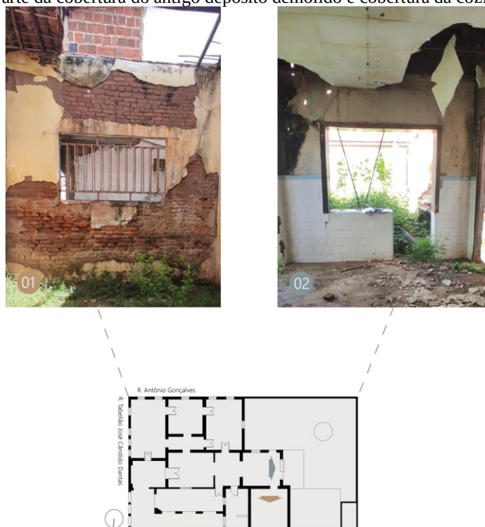
Figura 47 - Parte da cobertura do antigo depósito demolido e cobertura da cozinha comprometida.
