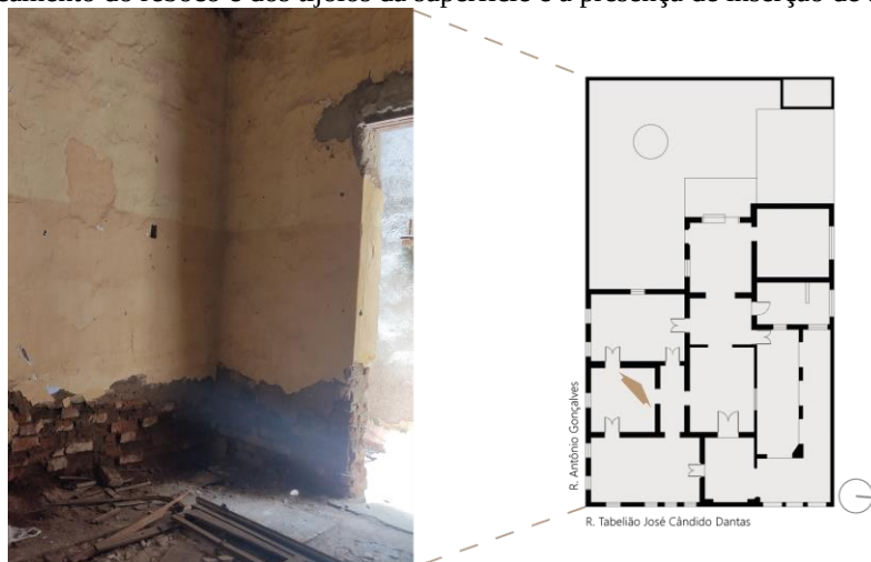
Figura 63 - Deslocamento do reboco e dos tijolos da superfície e a presença de inserção de argamassa.
