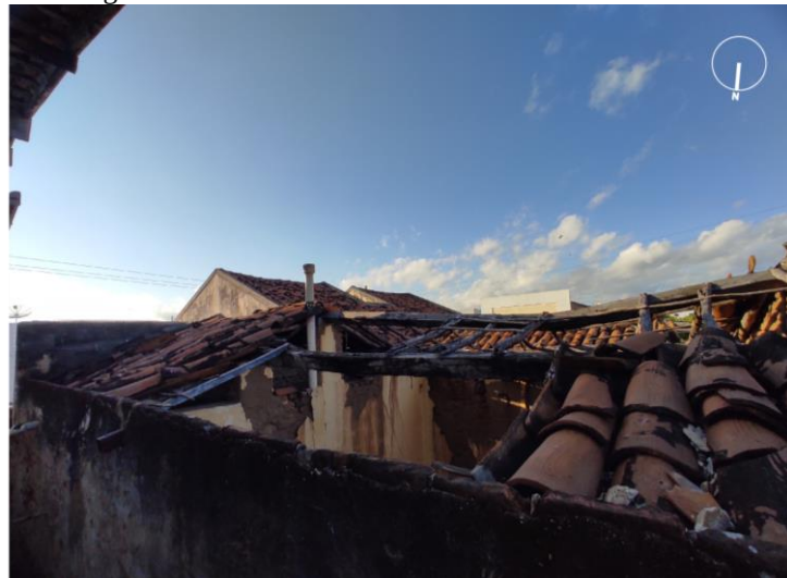
Figura 55 - Estado atual da cobertura do casarão.
