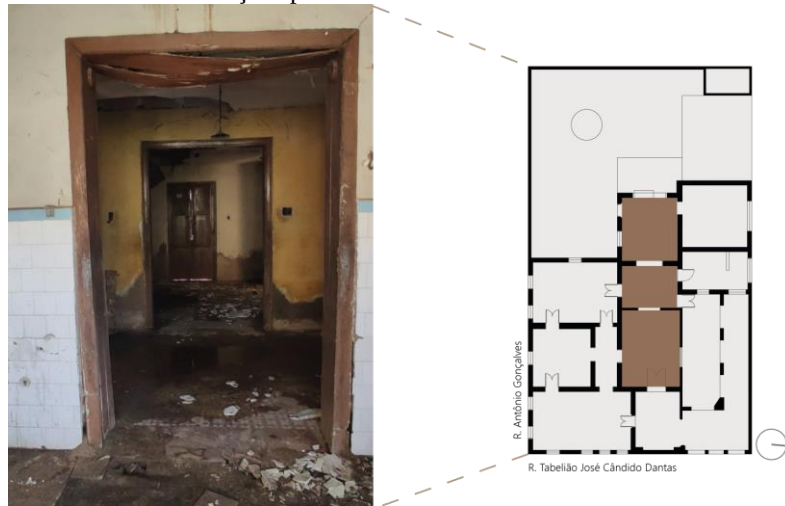
Figura 69 - Peças do piso faltantes e quebradiças com a área inundada pela água da chuva, consequência das condições precárias da cobertura.
