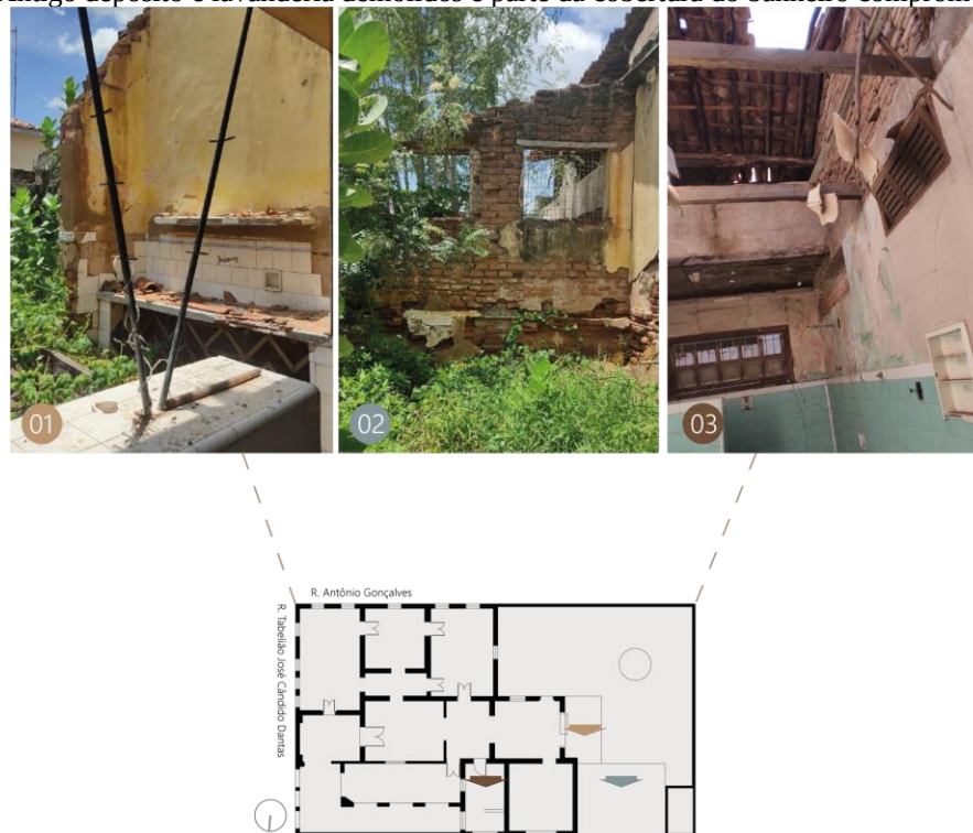
Figura 46 - Antigo depósito e lavanderia demolidos e parte da cobertura do banheiro comprometida.
