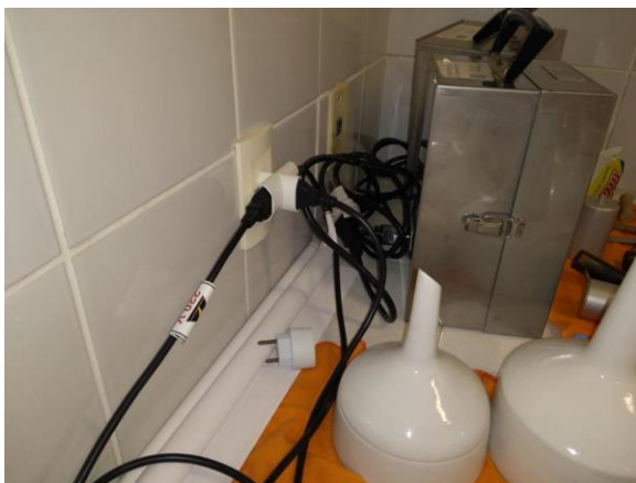
Figura 11. Organização da instalação elétrica (antes) Fonte: Autor (2018)
