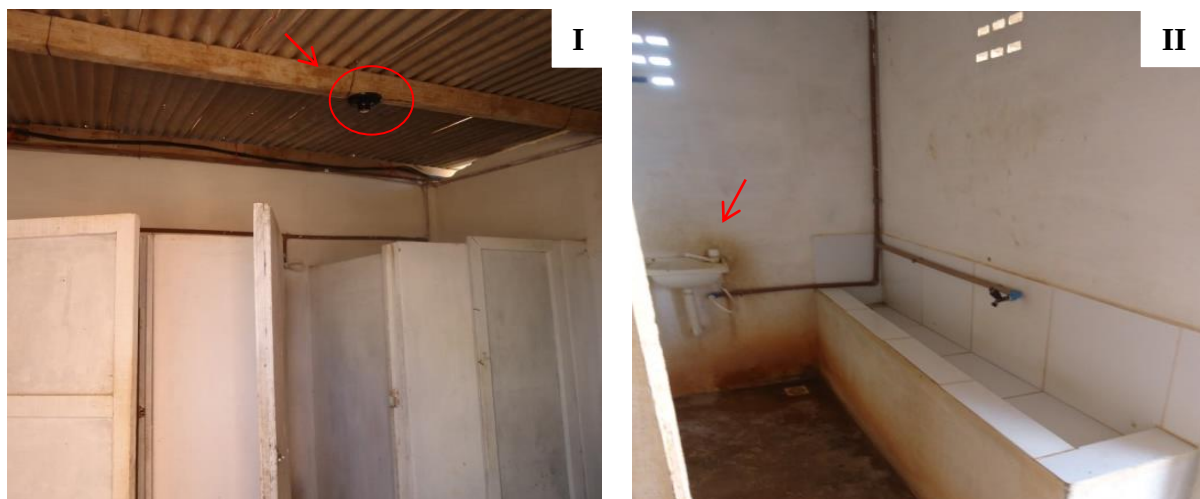
Figura 2 - Instalações sanitárias da Obra A
