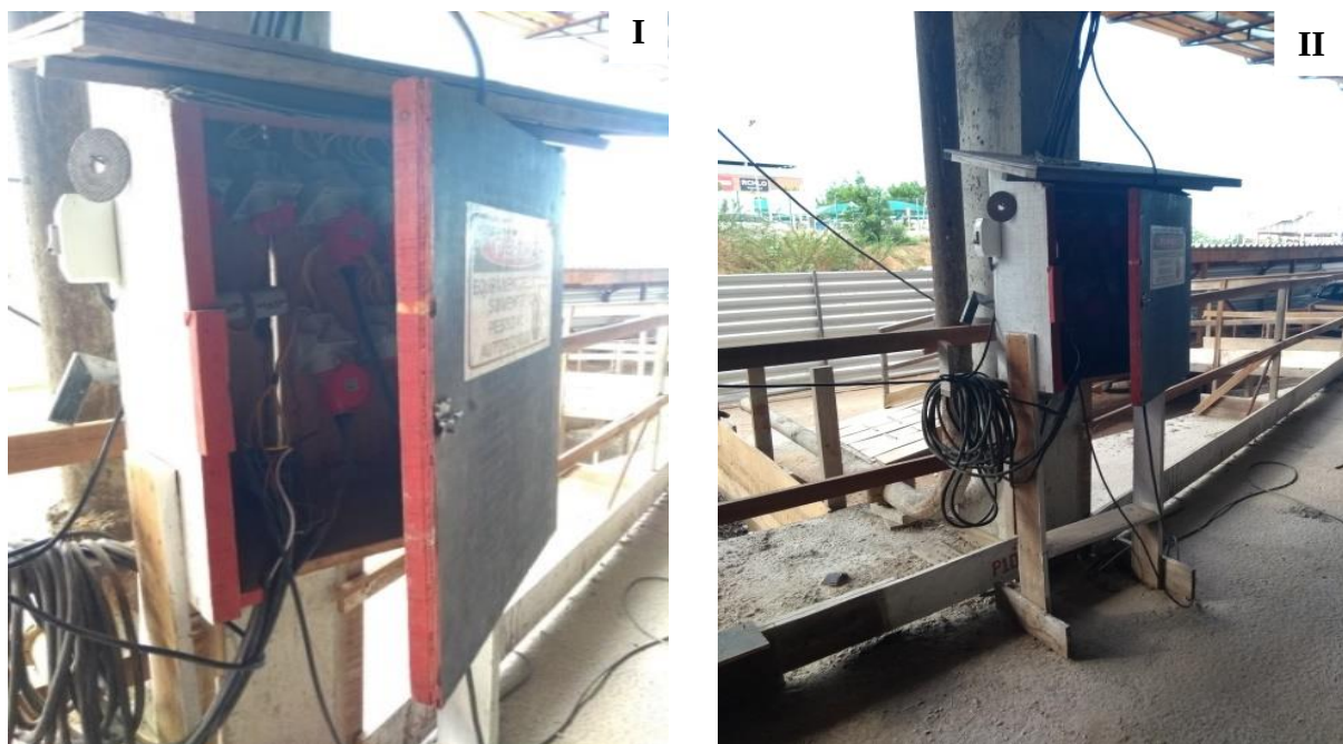
I: quadro geral de distribuição; II: isolamento dos cabos. Fonte: Dados da pesquisa (2018).
