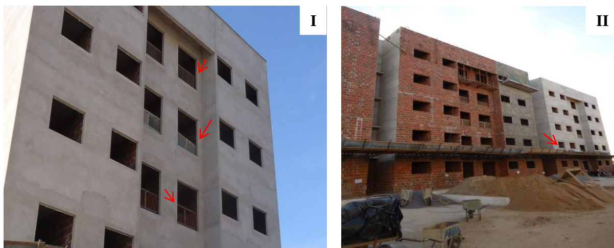
Figura 10 - Proteções contra queda de altura da Obra A
