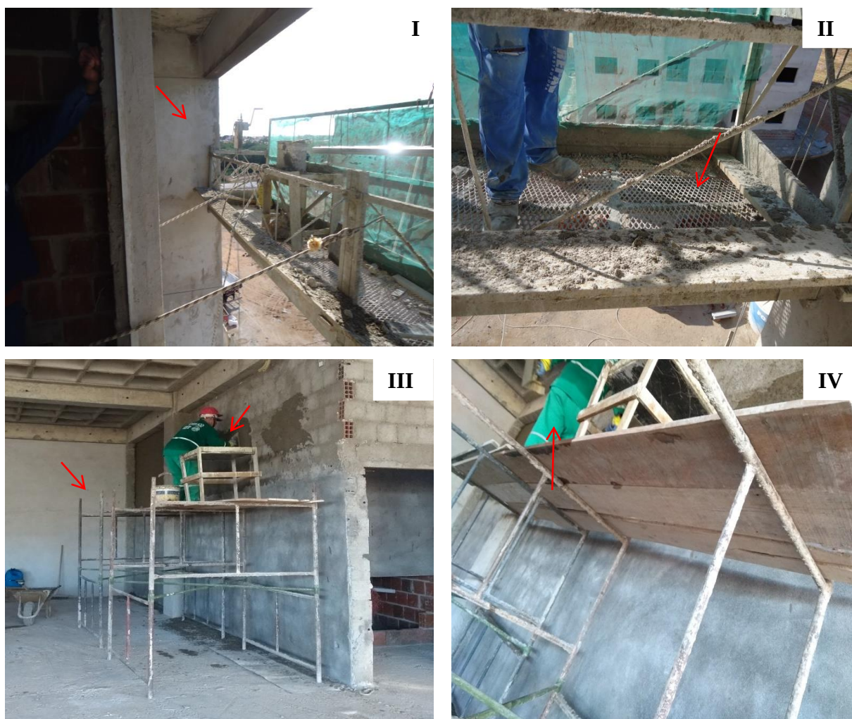
I: andaime suspenso da Obra A; II: Piso do andaime da Obra A; III: andaime simplesmente apoiado da obra B; IV: forração irregular do andaime da Obra B. Fonte: Dados da pesquisa (2018).
