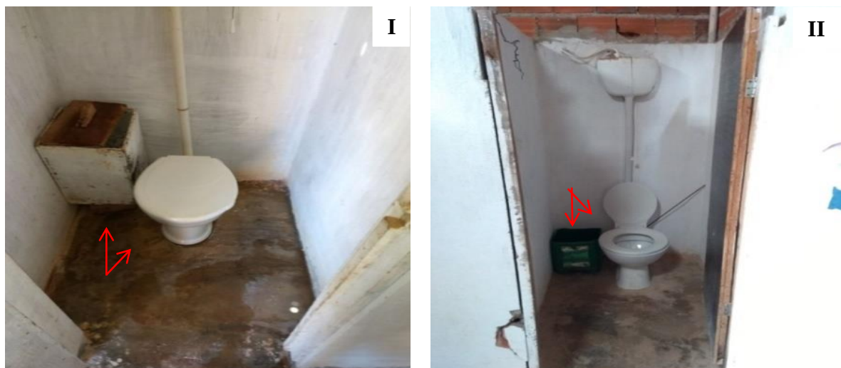
I: vaso sanitário da Obra A; II: vaso sanitário da obra B. Fonte: Dados da pesquisa (2018).
