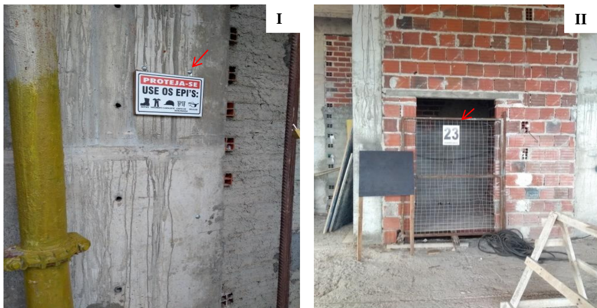
I: placa de EPI; II: ausência de placa indicando risco de queda. Fonte: Dados da pesquisa (2018).
