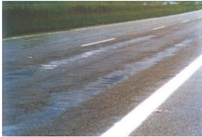
Figura 13 - Afundamento de consolidação em trilha de roda
