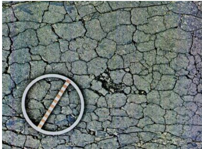
Figura 8 - Trinca tipo couro de jacaré
