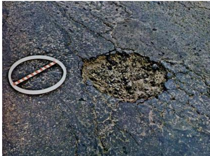
Figura 18 - Painéis ou buracos
