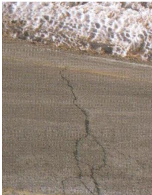
Figura 7 - Trinca de retração
