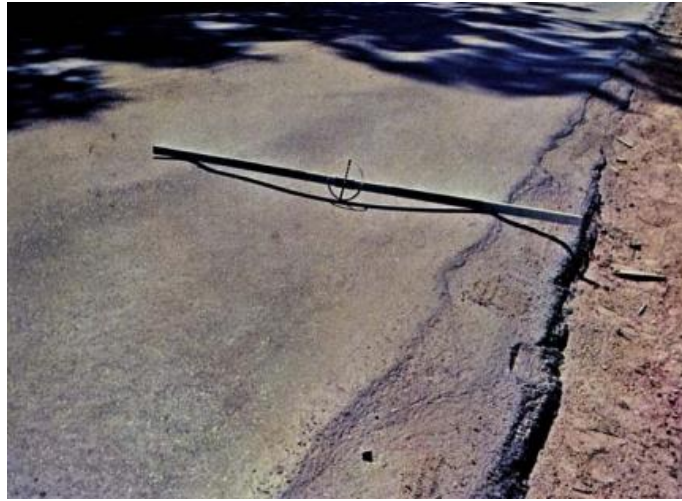
Figura 11 - Afundamento plástico em trilha de roda
