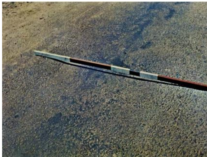
Figura 10 - Afundamento plástico local
