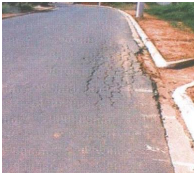
Figura 12 - Afundamento de consolidação local
