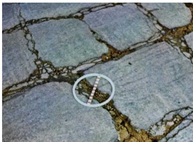
Figura 9 - Trincas em bloco
