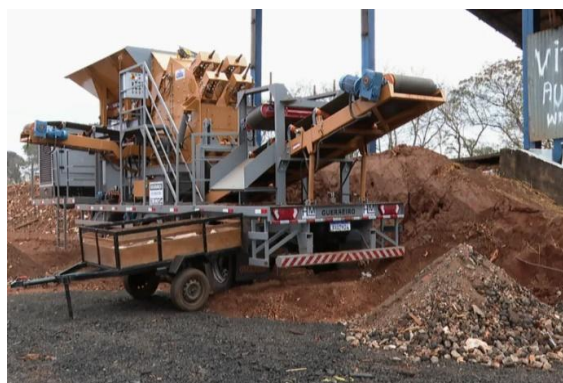
Figura 3- Usina de RCD Móvel
