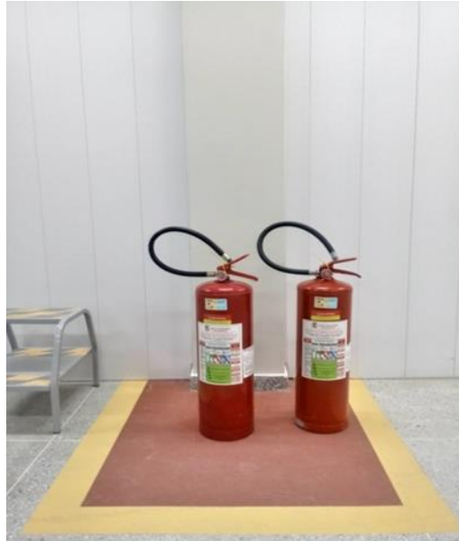
Figura 9 - Desconformidade referente à seta e altura.
