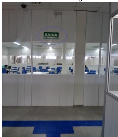
Figura 14 - Placa saída de emergência sem a direção.
