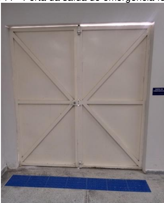
Figura 11 - Porta da saída de emergência fechada.
