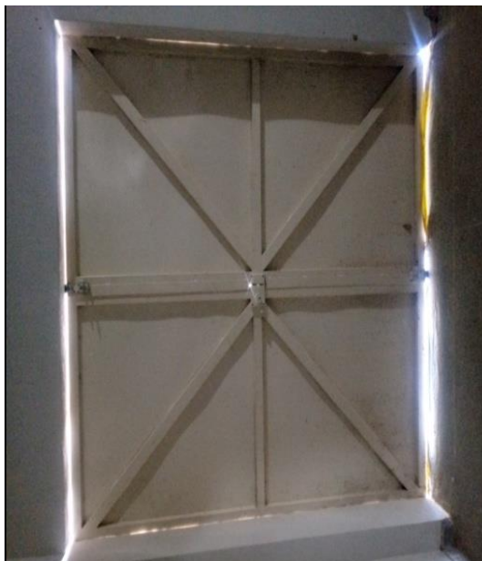
Figura 12 - Porta fechada no horário de funcionamento de trabalho.
