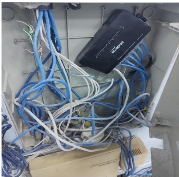
Figura 4 - Estrutura de rede comprometida.
