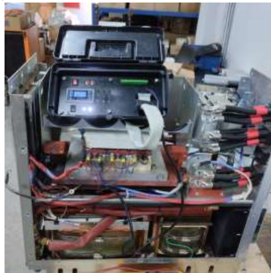
Fig. 19. Teste do módulo IGBT no inversor.
