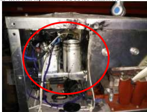
Fig. 9. Inversor com capacitores do BUS AC danificados.
