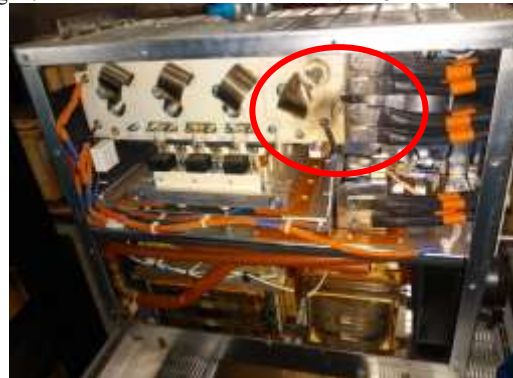
Fig. 10. Inversor com curto-circuito no LINK DC .
