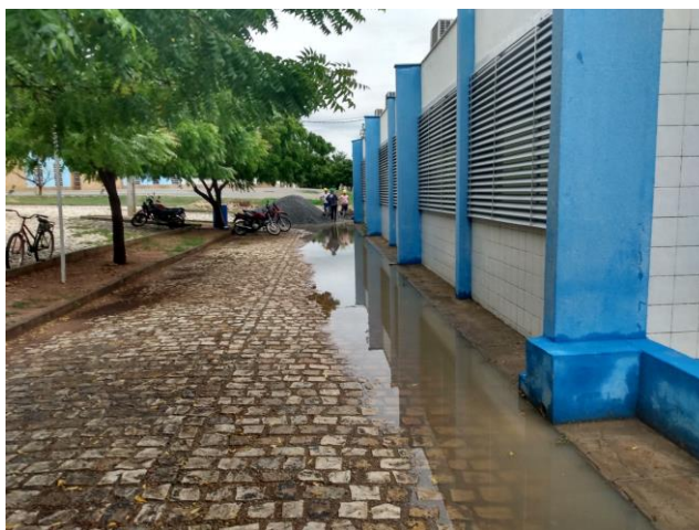
Figura 15. Acúmulo de água envolta da Central de Aulas II. Fonte: SIN (2019).
