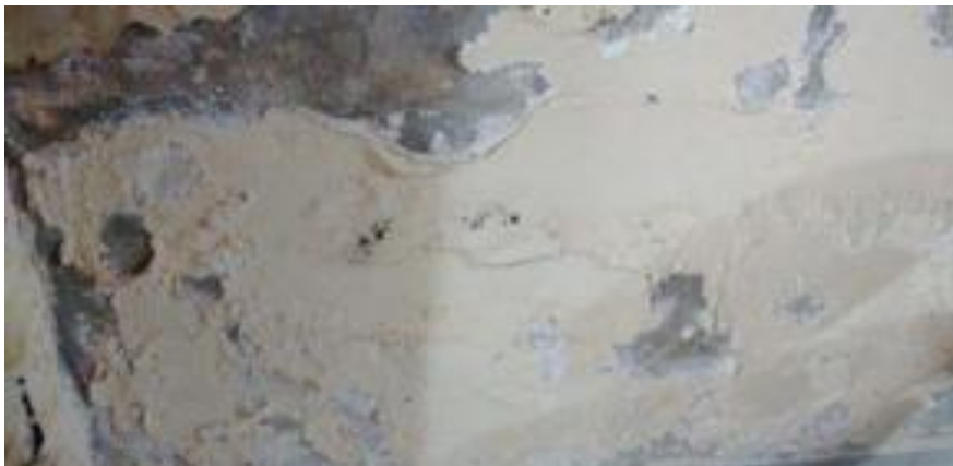
Figura 1. Eflorescência. Fonte: Ribeiro (2017).
