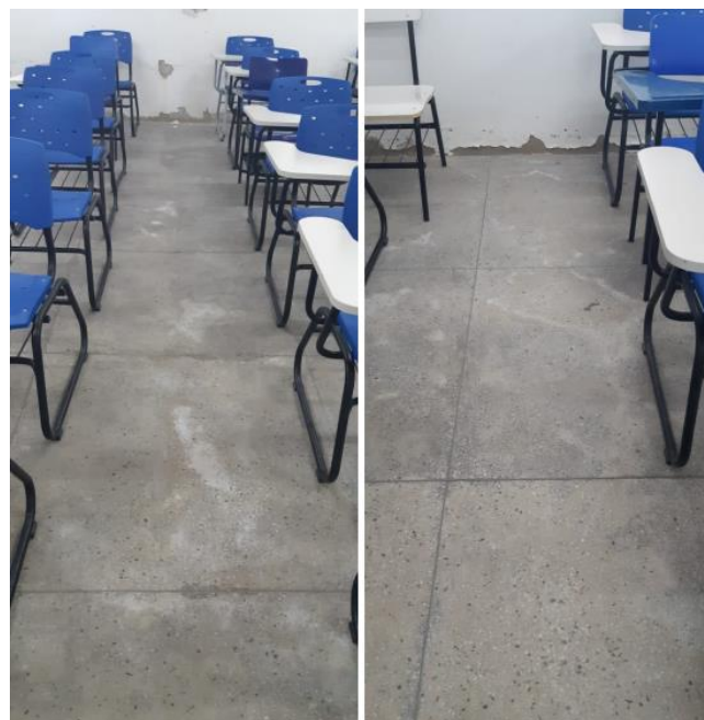
Figura 8. Umidade no piso. Fonte: SIN (2019).
