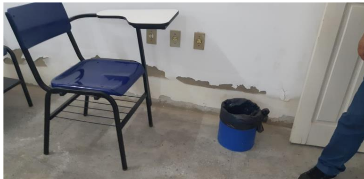
Figura 7. Eflorescência em paredes. Fonte: SIN (2019).
