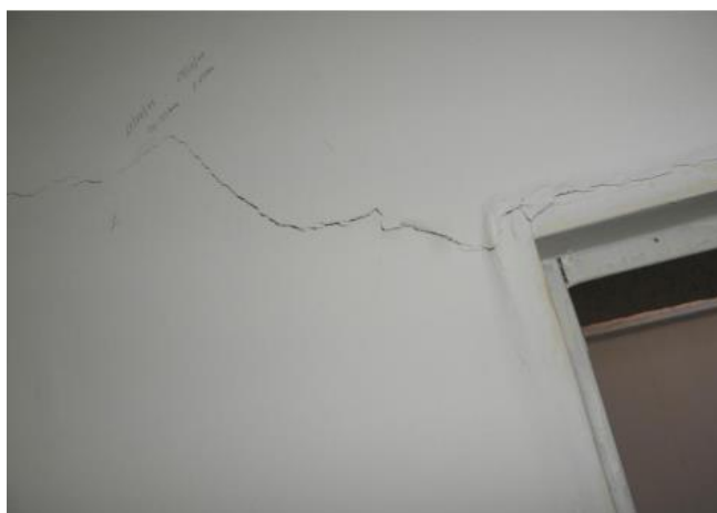
Figura 2. Fissura. Fonte: Alexandre (2012).
