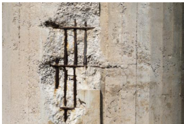
Figura 5. Corrosão. Fonte: Guide_Engenharia (2017).
