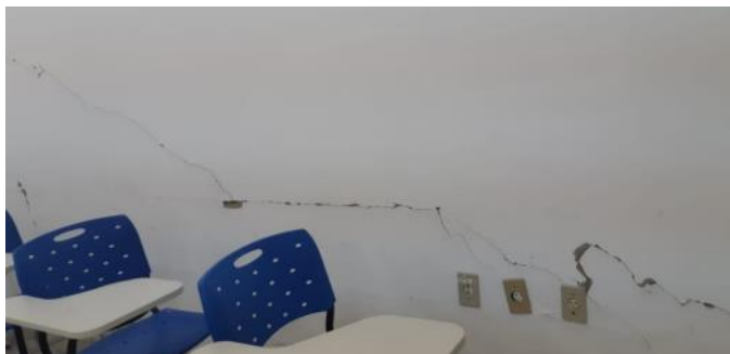
Figura 14. Fissuras na parede. Fonte: SIN (2019).
