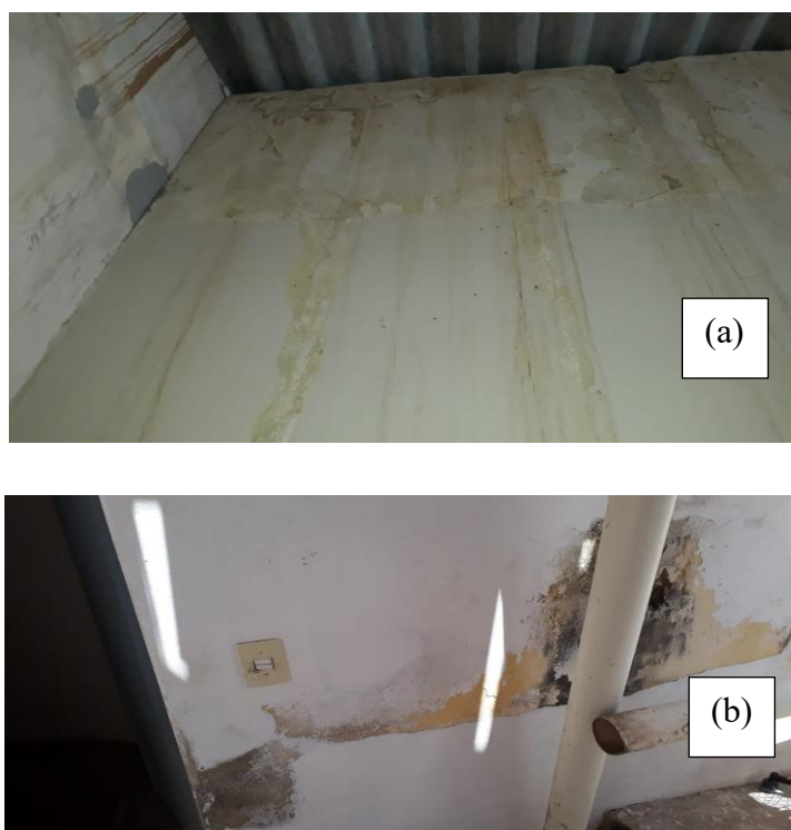
Figura 13- Infiltração e Umidade: (a) por falha no telhado; (b) por contato prolongado com água. Fonte: Elaborado pela Autora, (2025).
