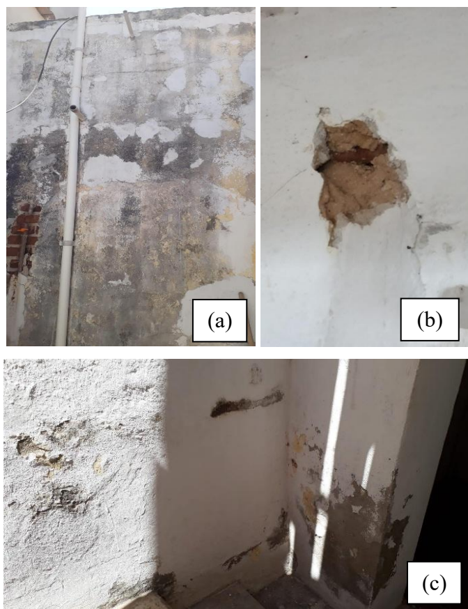
Figura 11 – Desagregamento do revestimento: (a) por infiltração e lavagem pela água da chuva; (b) perda de capacidade adesiva pela ação do tempo; (c) por umidade ascendente. Fonte: Elaborado pela Autora, (2025).
