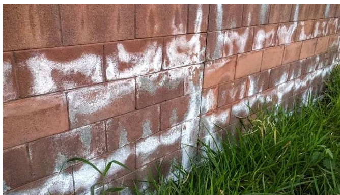
Figura 3- Ilustração de Eflorescência em área Externa.
