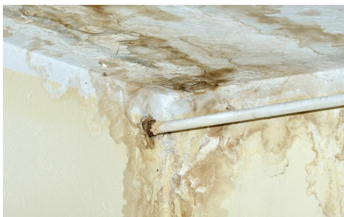
Figura 2- Ilustração de Infiltração e Umidade.
