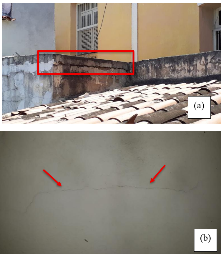
Figura 12- Aberturas em revestimentos: (a) por movimentação térmica; (b) por retração dos produtos à base de cimento. Fonte: Elaborado pela Autora, (2025).
