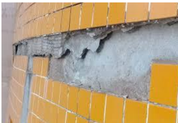
Figura 5- Ilustração de Desplacamento de Revestimento.
