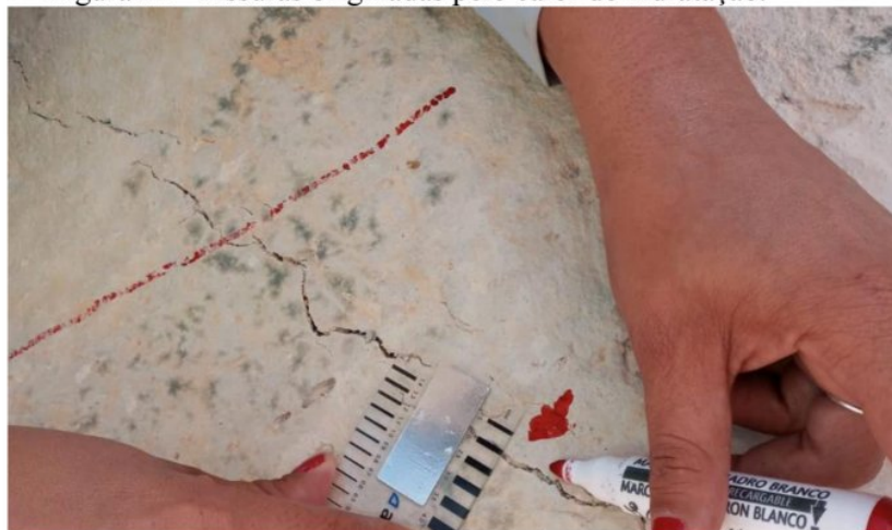
Figura 35 - Fissuras originadas pelo calor de hidratação.
