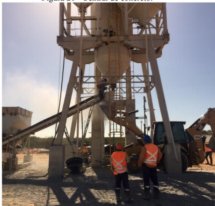
Figura 21 - Central de concreto.
