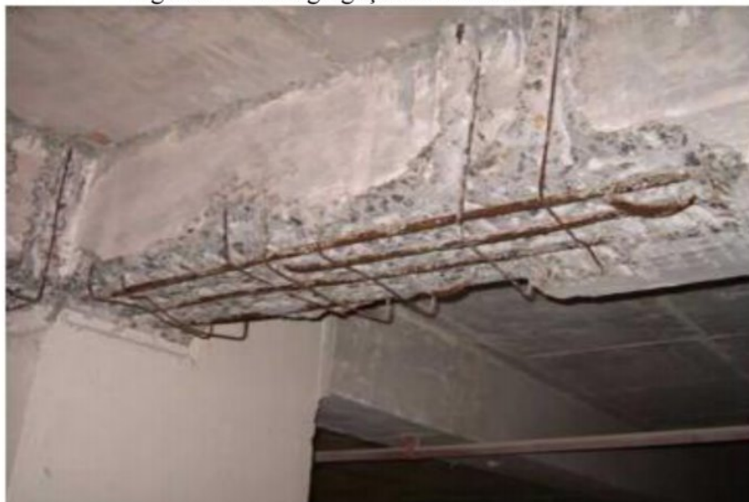
Figura 14 - Desagregação do concreto.
