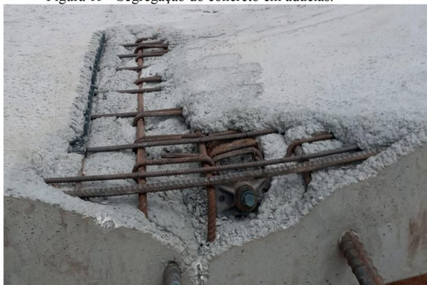
Figura 15 - Segregação do concreto em aduelas.
