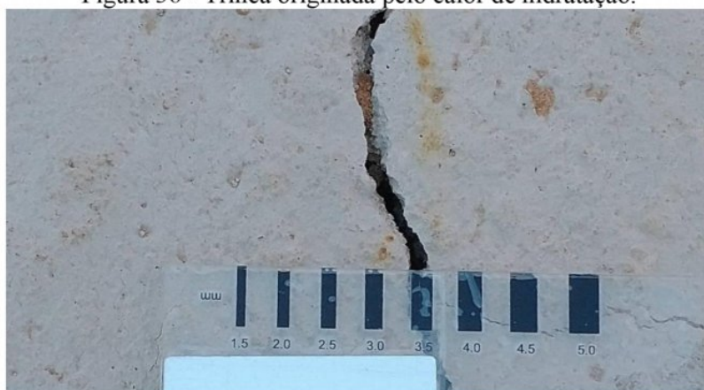
Figura 36 - Trinca originada pelo calor de hidratação.
