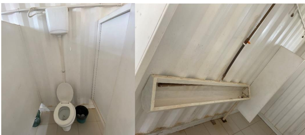
Figura 39: Instalações sanitárias: vasos sanitários e mictório.
