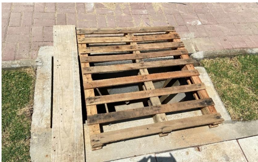
Figura 29: Abertura de piso com fechamento sem guarda corpo de rodapé.
