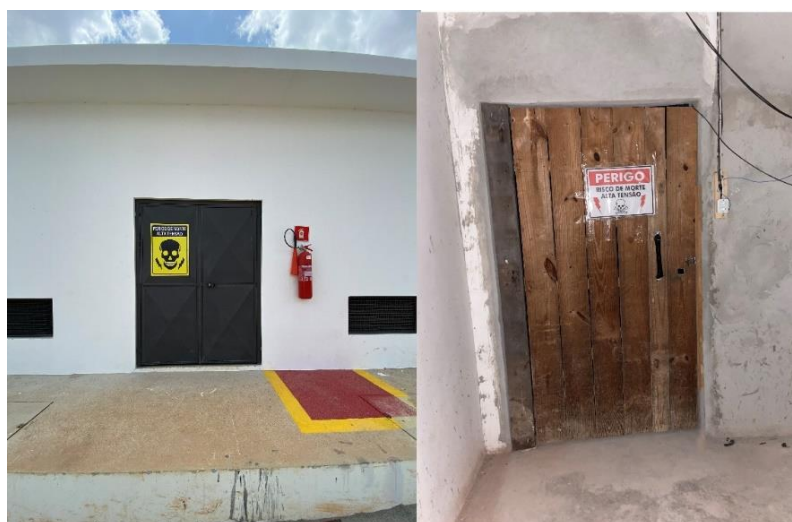
Figura 36: Fechamento e sinalização das áreas de transformadores.
