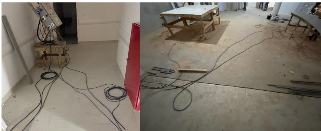
Figura 35: Cabos energizados em áreas de circulação.
