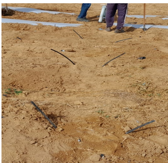
Figura 15: Tubulação principal e ramificações do sistema de irrigação.
