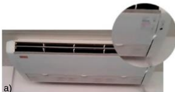
Figura 11: Condicionadores de ar da sala 9.
