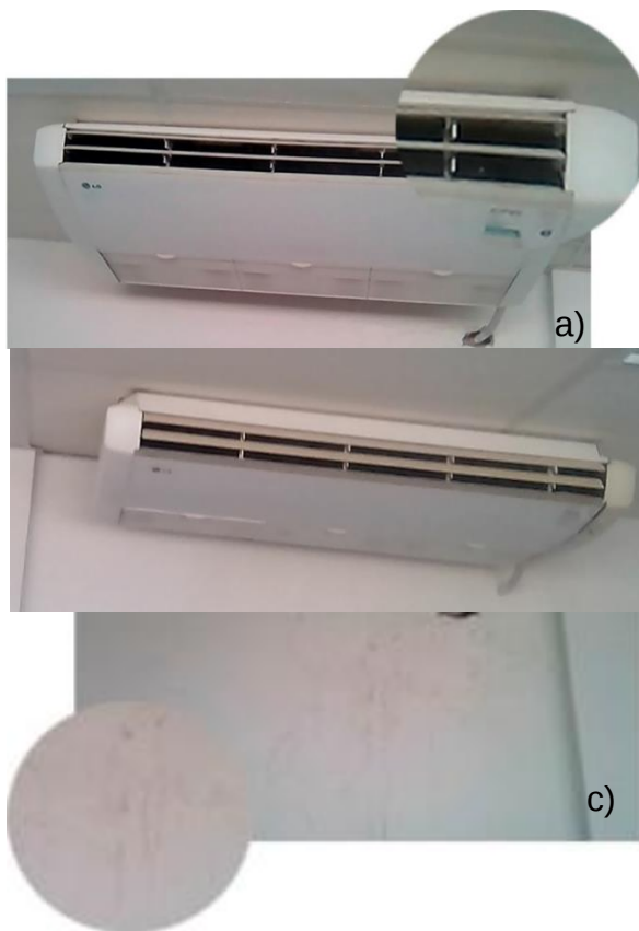
a) Condicionador de ar da frente, b) Condicionador de ar atrás c) detalhe da parede mofada. Fonte: Autoria própria (2018)
