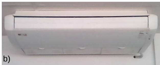
a) Condicionador de ar 1 e b) Condicionador de ar 2. Fonte: Autoria própria (2018)
