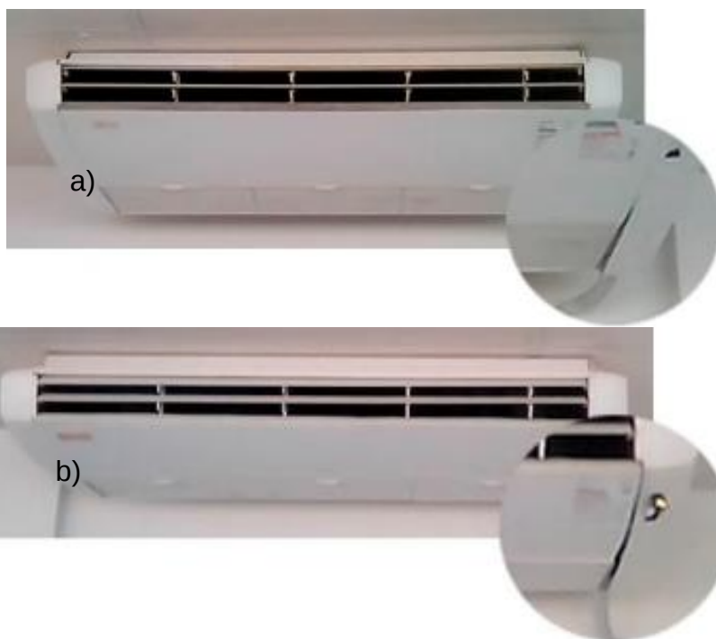
a) Ar condicionado frontal e b) ar condicionado traseiro. Fonte: Autoria própria (2018)
