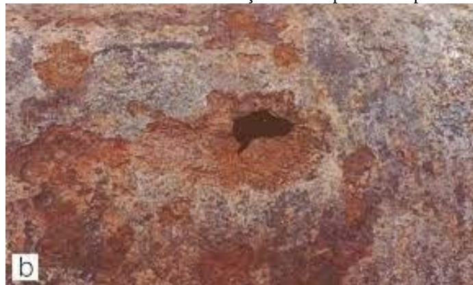
Figura 3: Corrosão eletrolítica em tubos de aço-carbono provocada por corrente de fuga.
