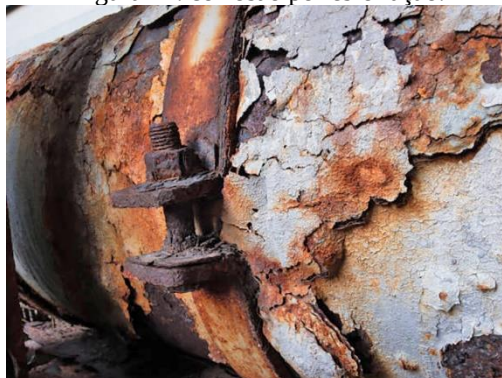
Figura 12: corrosão por esfoliação.
