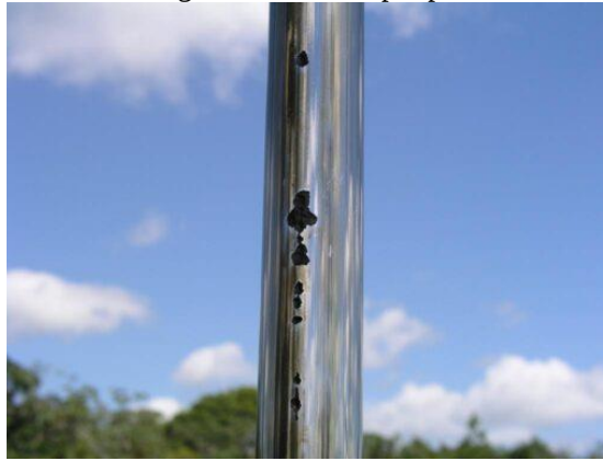
Figura 7: Corrosão por pite
