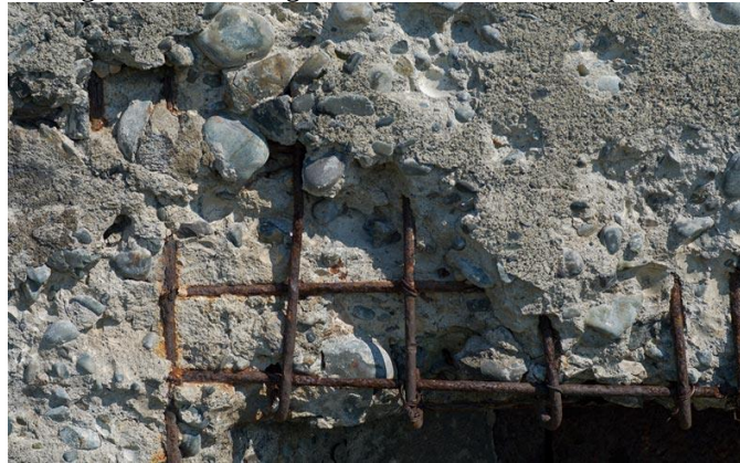
Figura 2: Metal desgastado devido a corrosão química.
