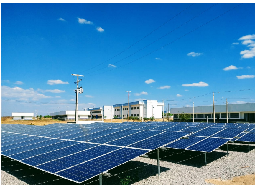
Figura 13 – Usina Solo da UFERSA Campus Caraúbas
