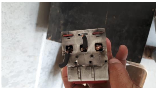
Fig 15. Disjuntor danificado devido a ação de ponto quente. Fonte: Autoria Própria.
