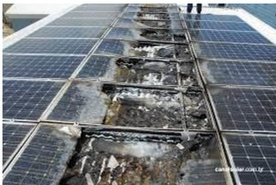
Fig 11. Módulos solares danificados devido ao sombreamento excessivo. Fonte: [9].
