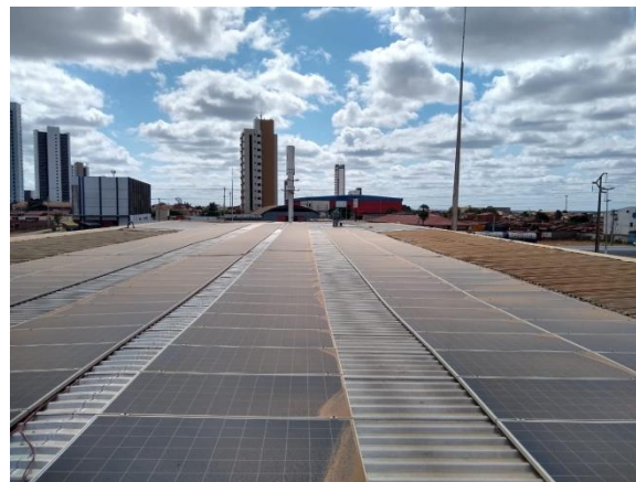
Fig 12. Conjunto de módulos instalados sobre um telhado de um posto de combustíveis na cidade de Mossoró/RN. Fonte: Autoria Própria.
