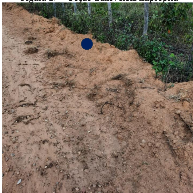
Figura 17 – Seção transversal imprópria
