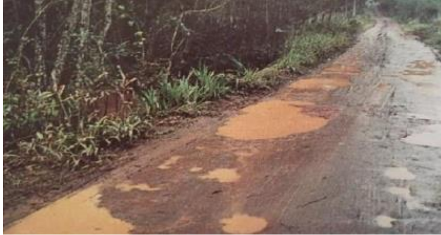
Figura 2 – Estrada vicinal com buracos no pavimento
