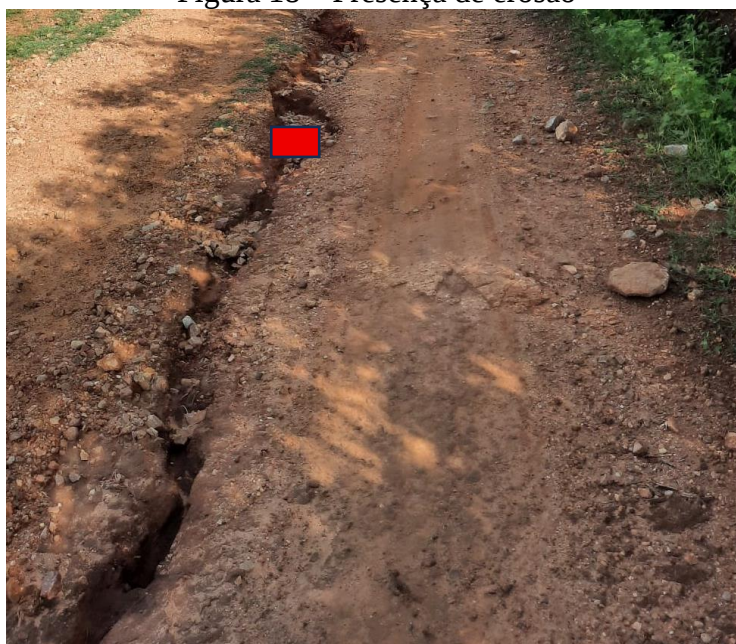
Figura 18 – Presença de erosão
