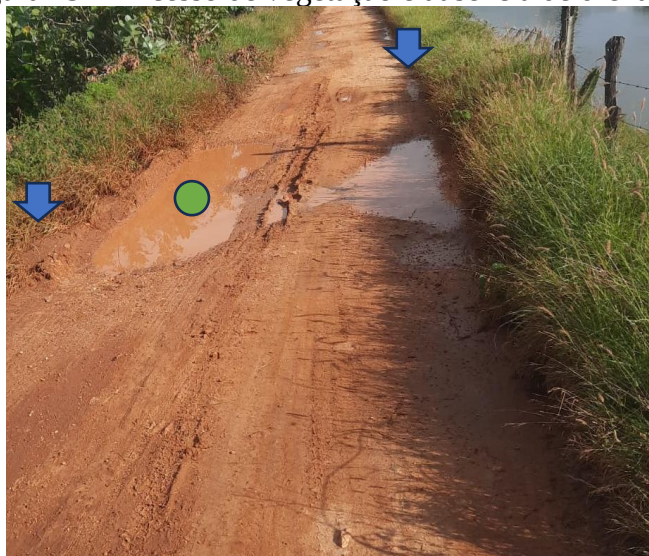
Figura 19 – Excesso de vegetação e ausência de drenagem
