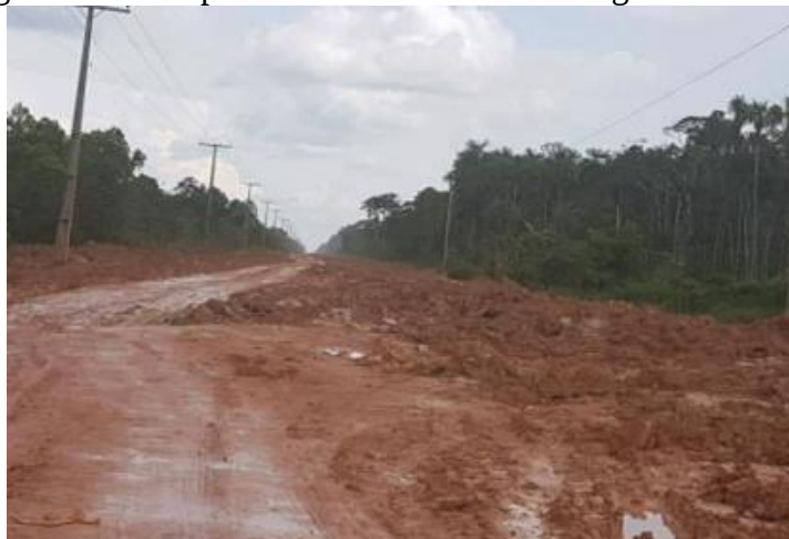
Figura 8 – Exemplo de estrada vicinal com seguimento crítico
