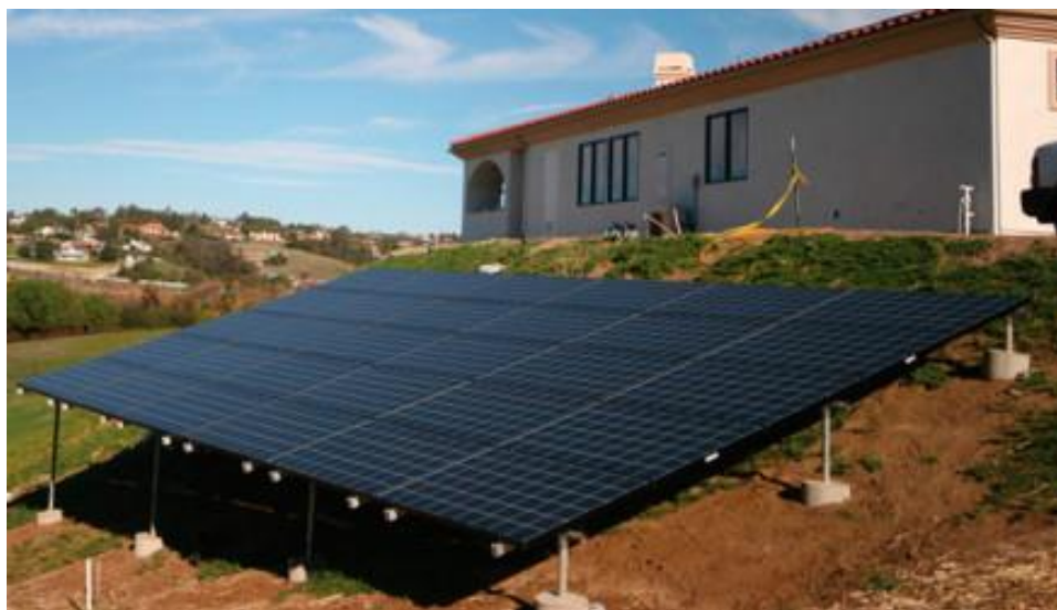
Figura 10. Sistema instalado off-grid .
