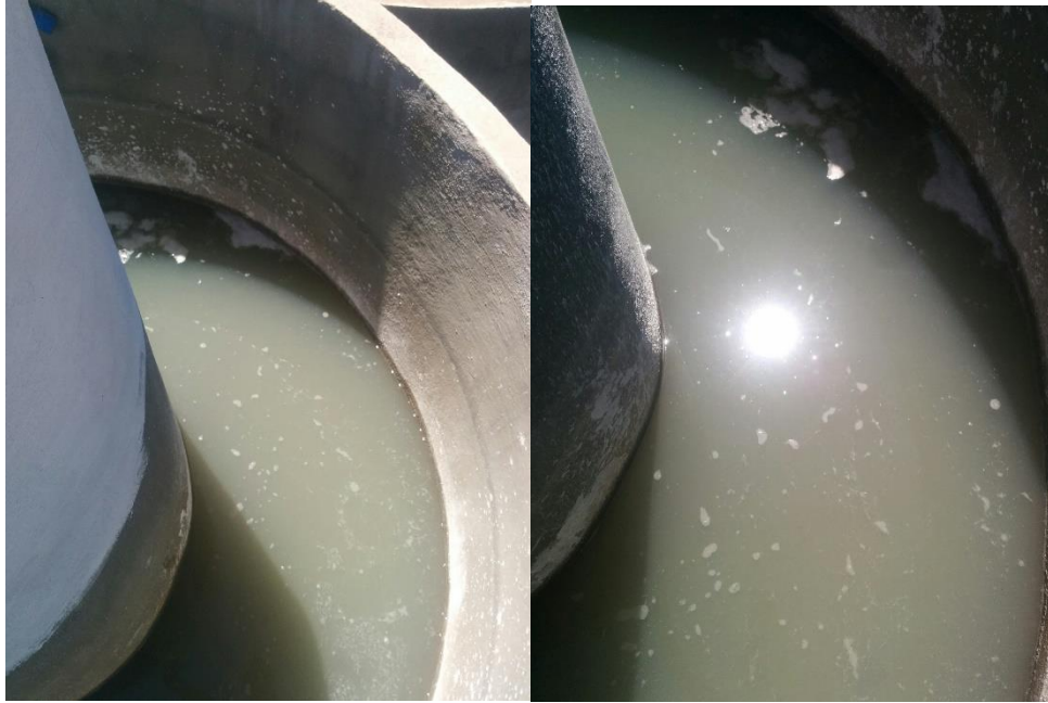
Figura 06: Tanque de estabilização da ETEI
