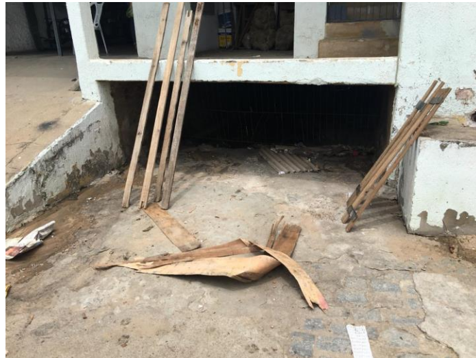
Figura 15: Bueiro existente na área de estudo
