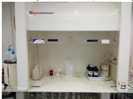
Figura 04 – Capela de exaustão (Autoria Própria).
