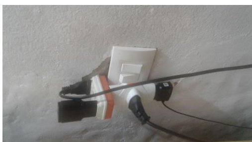
Figura 9: Sobrecarga na tomada
