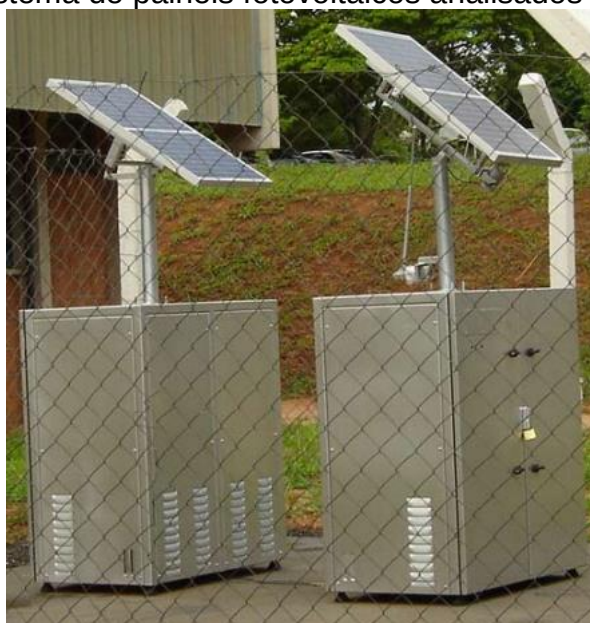
Figura 27 – Sistema de painéis fotovoltaicos analisados em Alves, 2008
