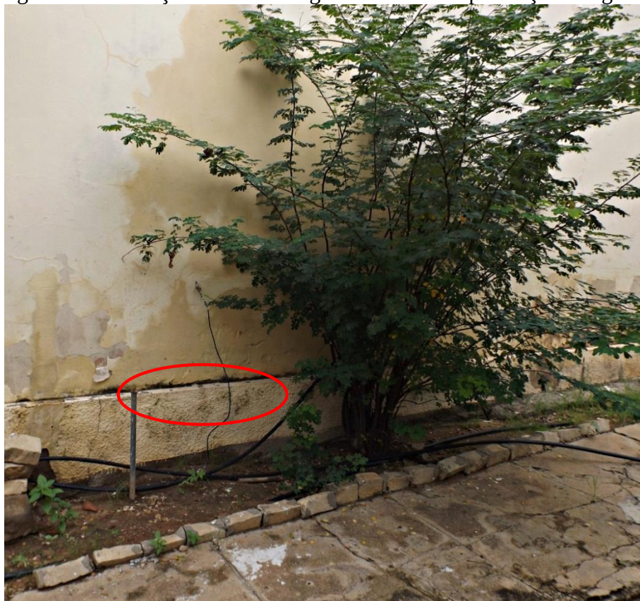
Figura 34. Infiltração na fachada agravada devido à presença de vegetação
