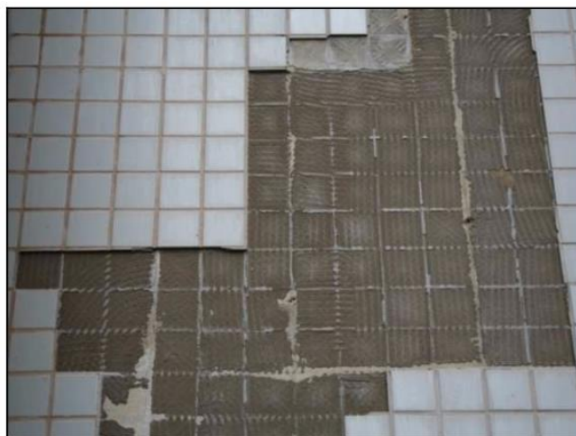
Figura 24. Desplacamento localizado da cerâmica
