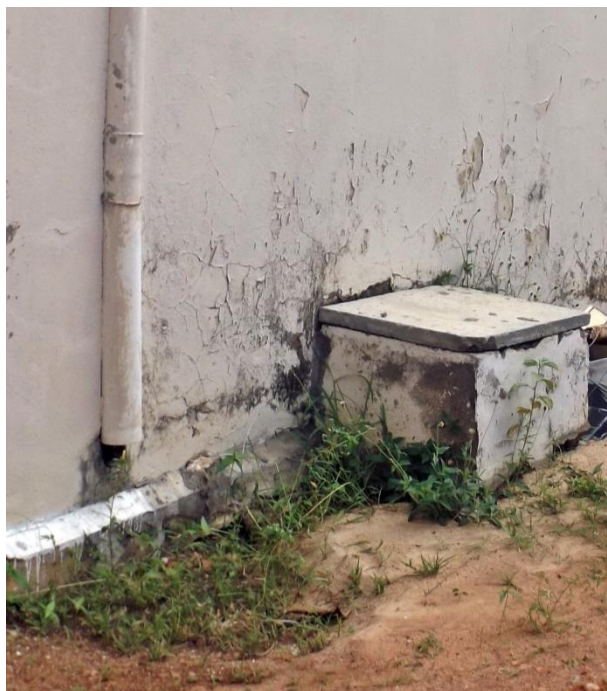
Figura 29. Formação de bolor na região inferior da fachada
