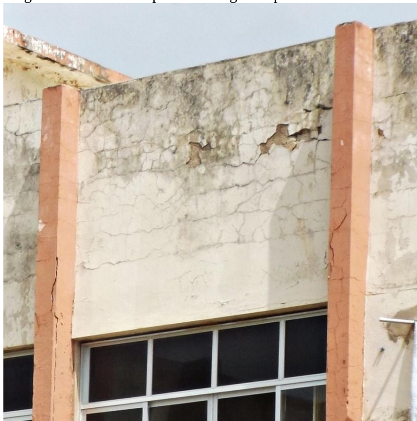
Figura 31. Fissuras mapeadas na região superior da fachada
