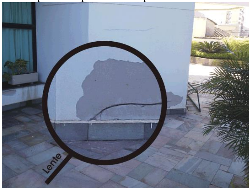
Figura 22. Pulverulência do reboco/emboço provocada por umidade percolante proveniente do piso
