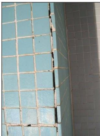
Figura 19. Falha na junta de assentamento
