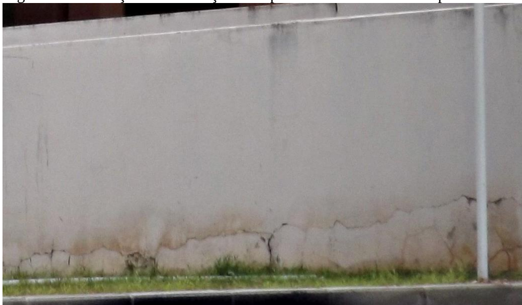
Figura 35. Infiltração devido à ação da capilaridade na lateral a rampa de acesso
