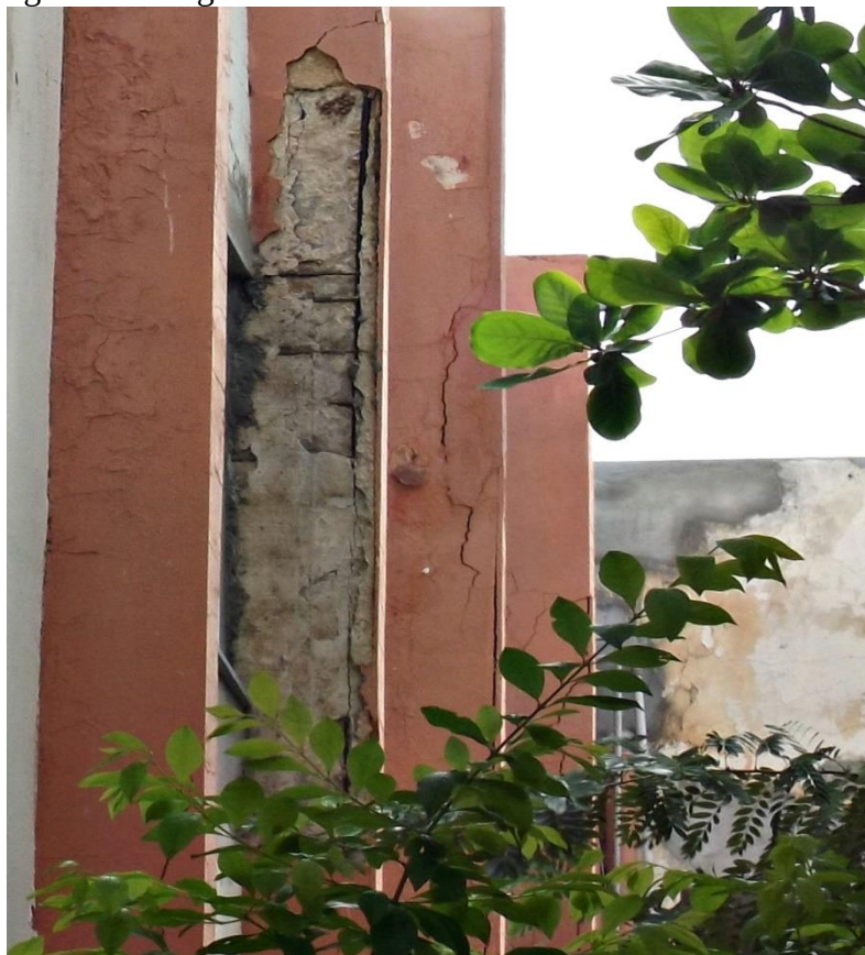
Figura 32. Progressão da fissura e descolamento do revestimento
