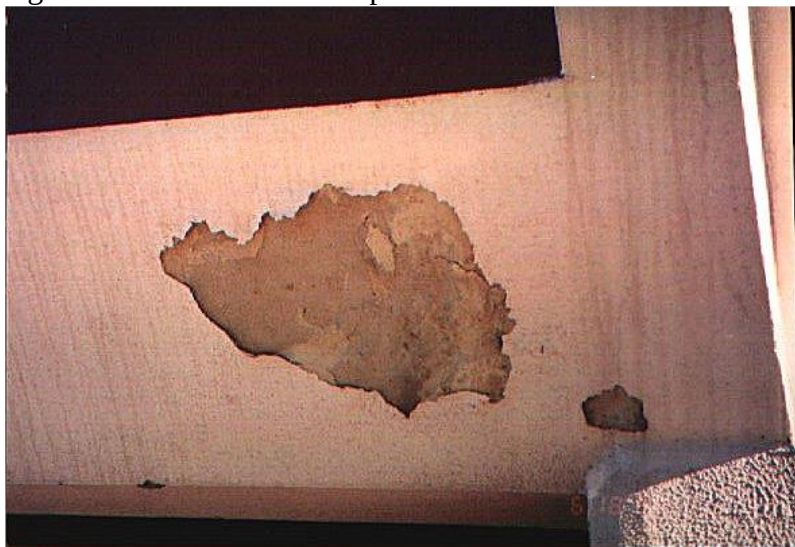
Figura 21. Deslocamento de placas
