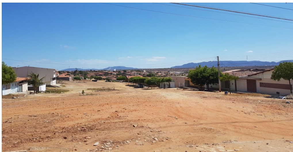
Figura 11: Ruas sem pavimentação no Bairro Manoel Deodato Pau dos Ferros-RN
