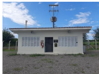
Fig. 8. Abrigo dos inversores da minigeração fotovoltaica da UFERSA – Campus Mossoró [Autoria própria].
