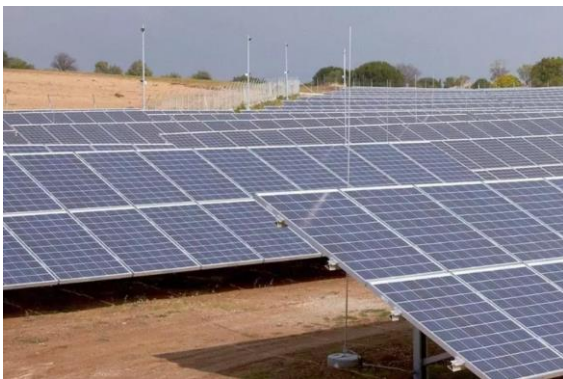
Fig. 6. Instalações reais de um SPDA em um sistema fotovoltaico [12].
