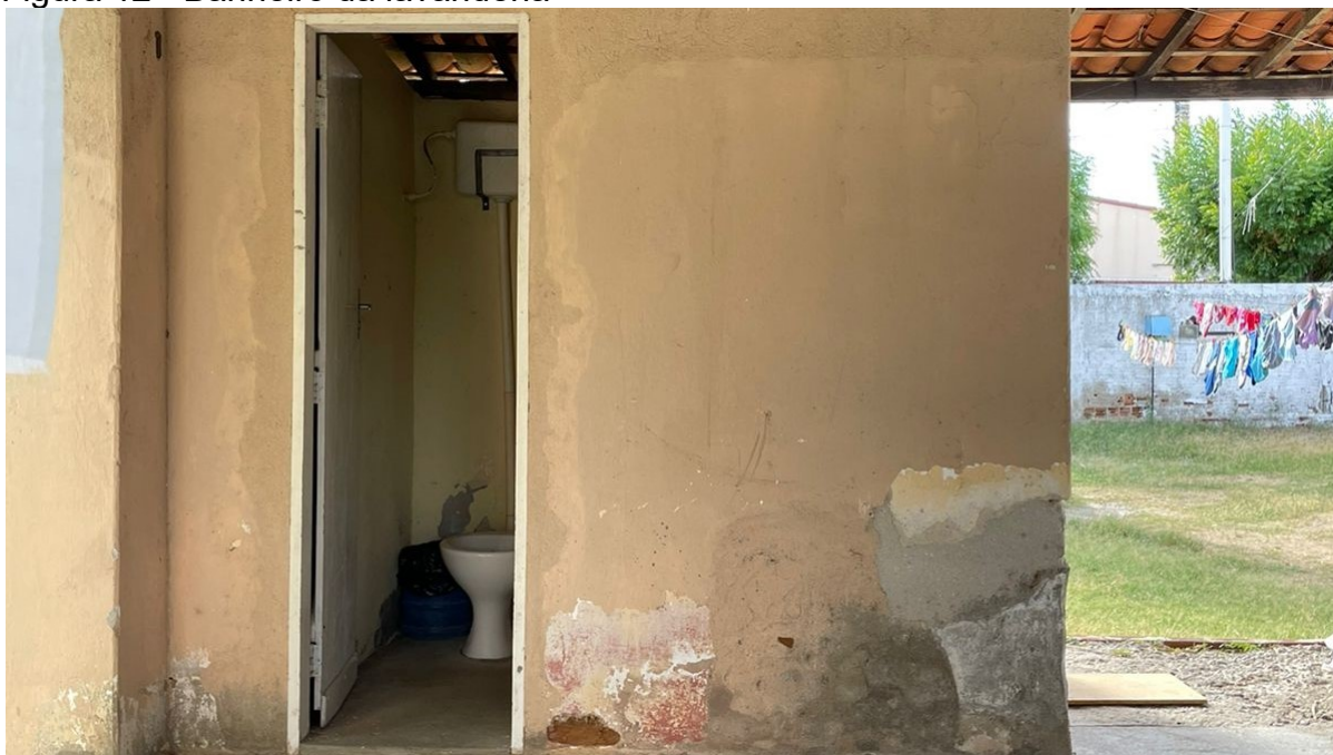
Figura 12 - Banheiro da lavanderia
