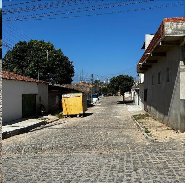
Figura 25: Rua Prof. Viária do Socorro, passeio desnovelado
