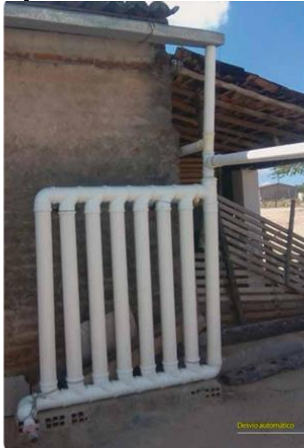
Figura 11: Desvio automático instalado na calha.
