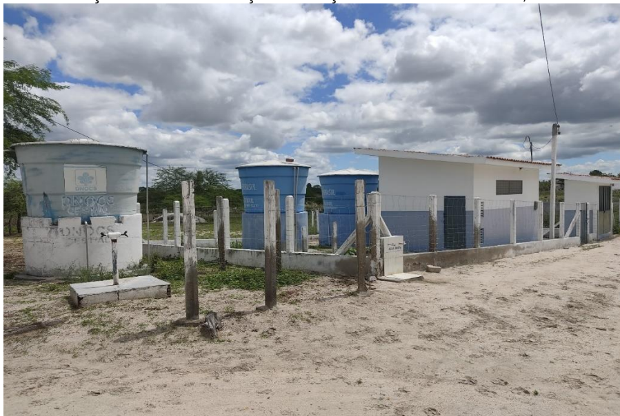
Figura 13: Estação de Dessalinização de Poço Artesiano. Brasilinha, Ouro Branco/AL.
