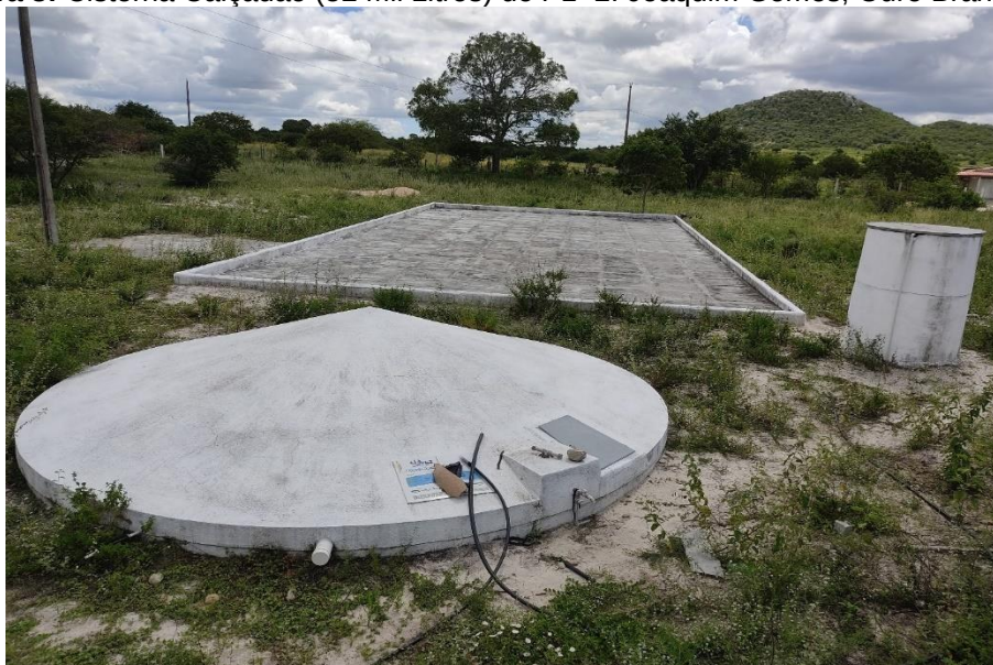
Figura 8: Cisterna Calçadão (52 Mil Litros) do P1+2. Joaquim Gomes, Ouro Branco/AL.
