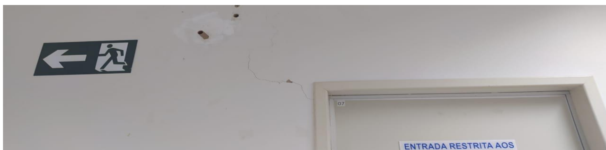
Figura 36 – Fissura diagonal no canto superior da esquadria no Acervo Geral
