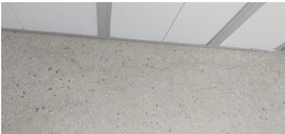
Figura 25 – Fissuras e Trincas no Salão de Leitura
