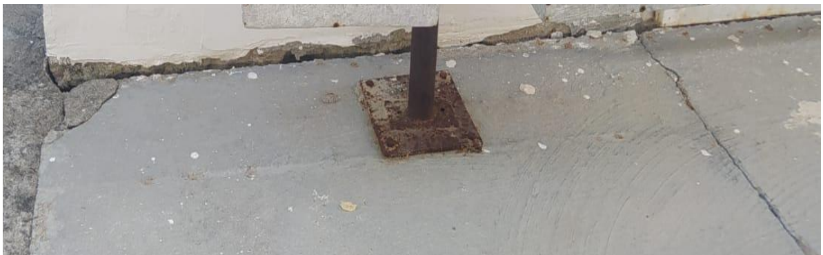
Figuras 16 – Fissura de Deslizamento na parte externa da edificação
