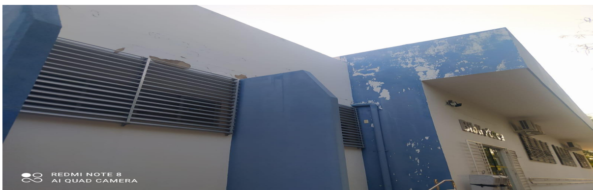
Figura 56 – Descolamento em placas na parte frontal externa do prédio da Biblioteca
