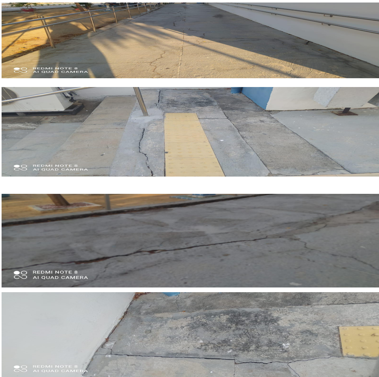
Figura 18 – Fissuras e Trincas nas escadas, rampa de acesso e piso externo
