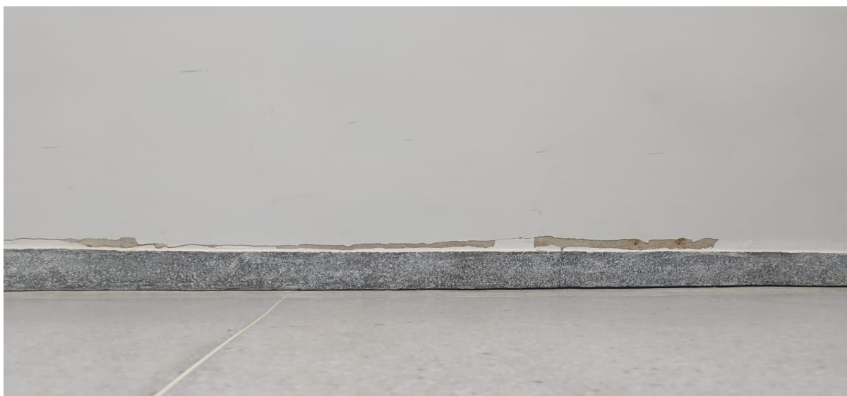
Figura 12 – Fissura de Deslizamento no Acervo Geral
