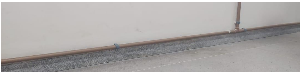
Figuras 15 – Fissura de Deslizamento na Sala de Estudos em Grupo
