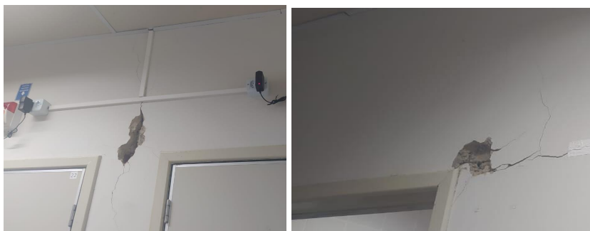
Figura 59 – Desagregação em revestimento de pintura no Hall de Circulação de Serviço
