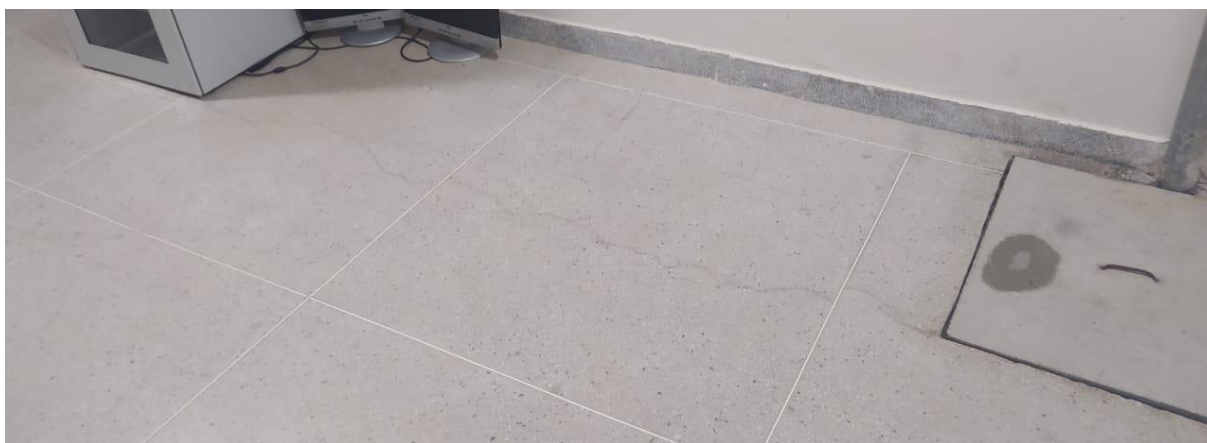
Figura 26 – Fissuras e Trincas na Sala Técnica de Informática
