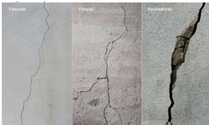
Figura 5- Exemplo de fissuras, trincas e rachaduras
