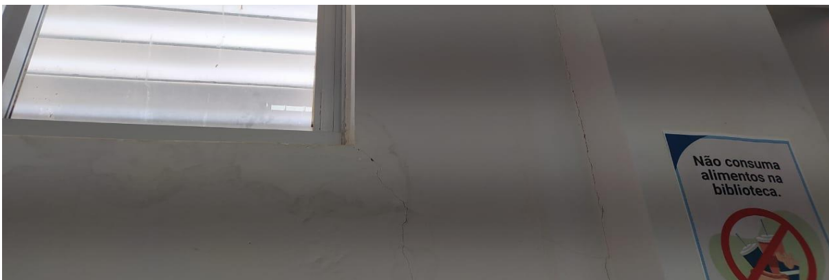
Figura 40 – Fissuras geométricas no canto inferior da esquadria entre alvenaria e pilar no Gabinete de Estudos Individuais
