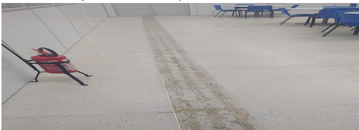
Figura 31 – Descolamento de pisos táteis no Salão de Leitura
