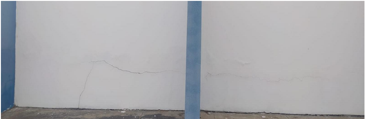
Figura 47 – Trincas na parte lateral oeste, leste e frontal externa do prédio
