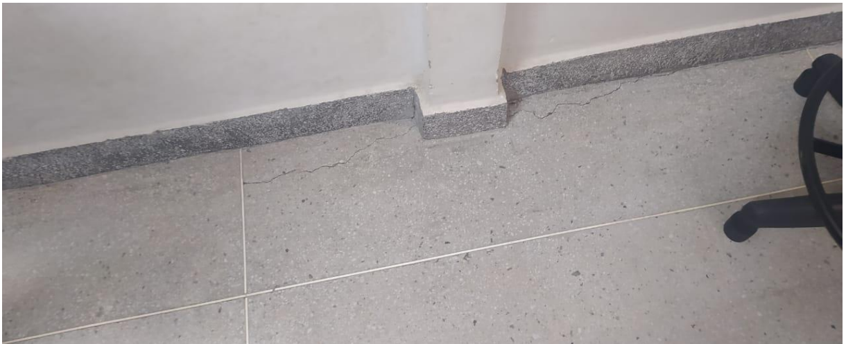
Figura 22 – Fissuras e Trincas no Guarda Volume
