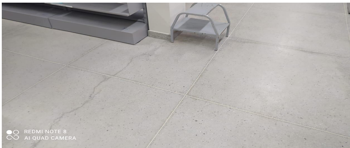
Figura 19 – Fissuras e Trincas no Acervo Geral
