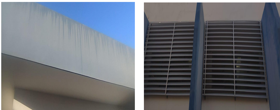
Figura 53 – Desbotamento na parte externa do prédio
