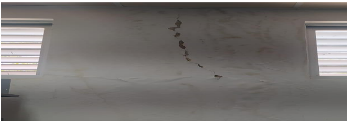
Figura 52 – Manchas de Umidade por infiltração por vazamento no Acervo Reserva
