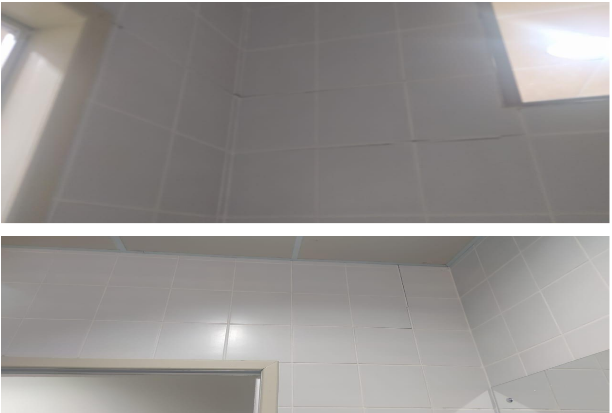
Figura 43 – Trincas entre juntas de dilatação no banheiro dos usuários
