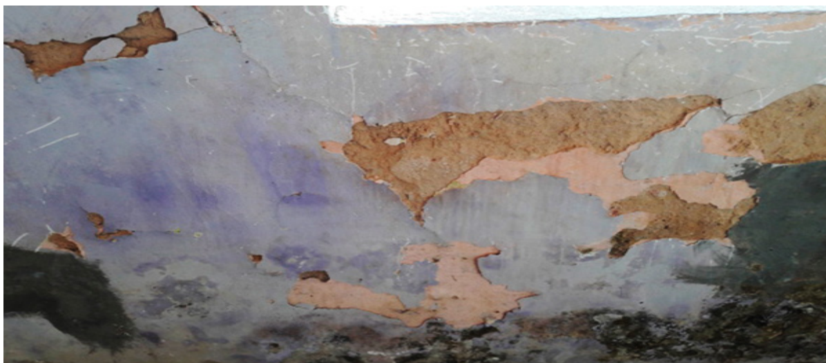
Figura 6 - Descolamento em revestimentos argamassados
