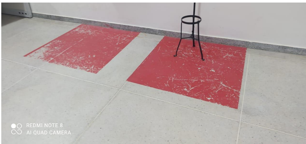
Figura 27 – Desagregação de pintura no Acervo Geral
