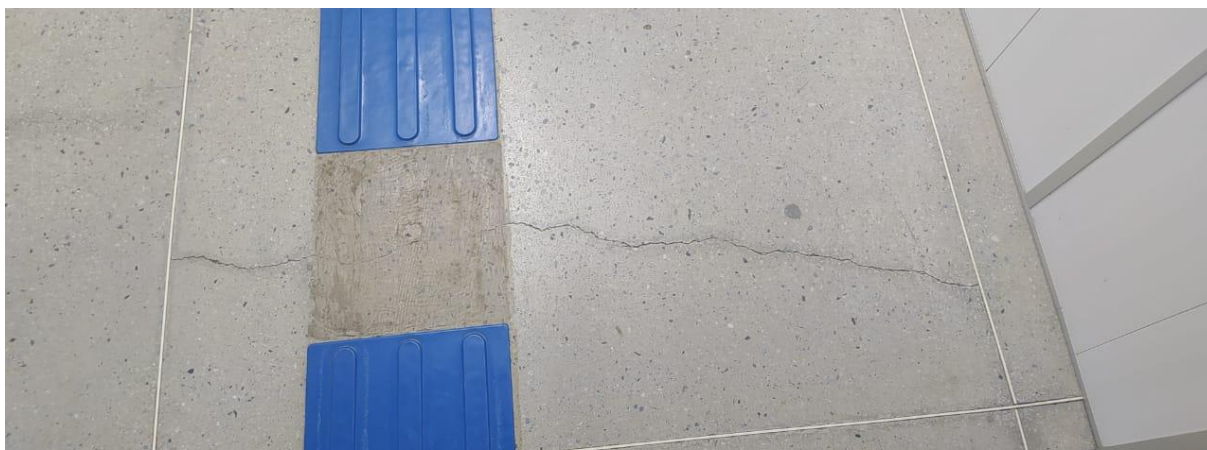
Figura 30 – Descolamento de pisos táteis no Hall de Circulação de Serviço
