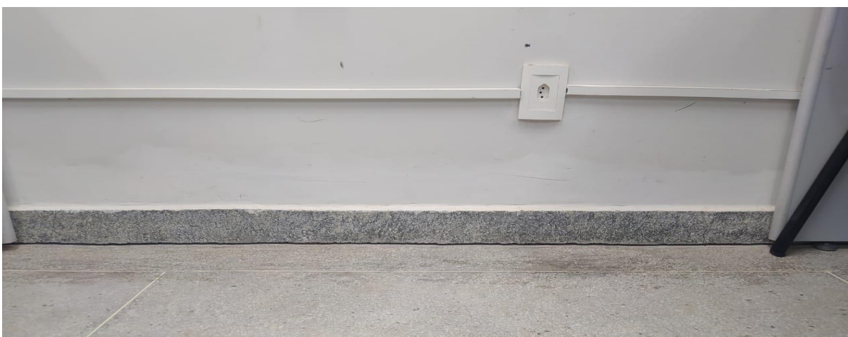
Figura 14 – Fissura de Deslizamento no Gabinete de Estudos Individuais
