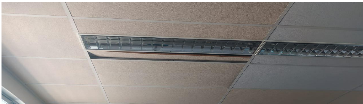
Figura 69 – Desencaixe de placas modulares de PVC na Sala de Restauração
