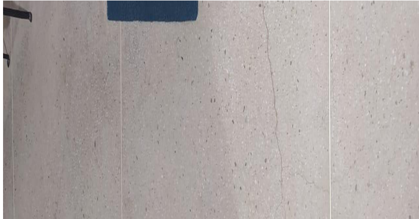
Figura 20 – Fissura e Trincas no Hall de Circulação de Serviço
