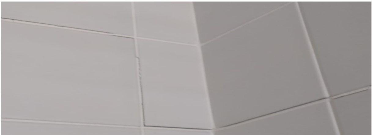
Figura 48 – Trincas nas juntas de assentamento do revestimento cerâmico do BWC feminino e masculino restrito a funcionários
