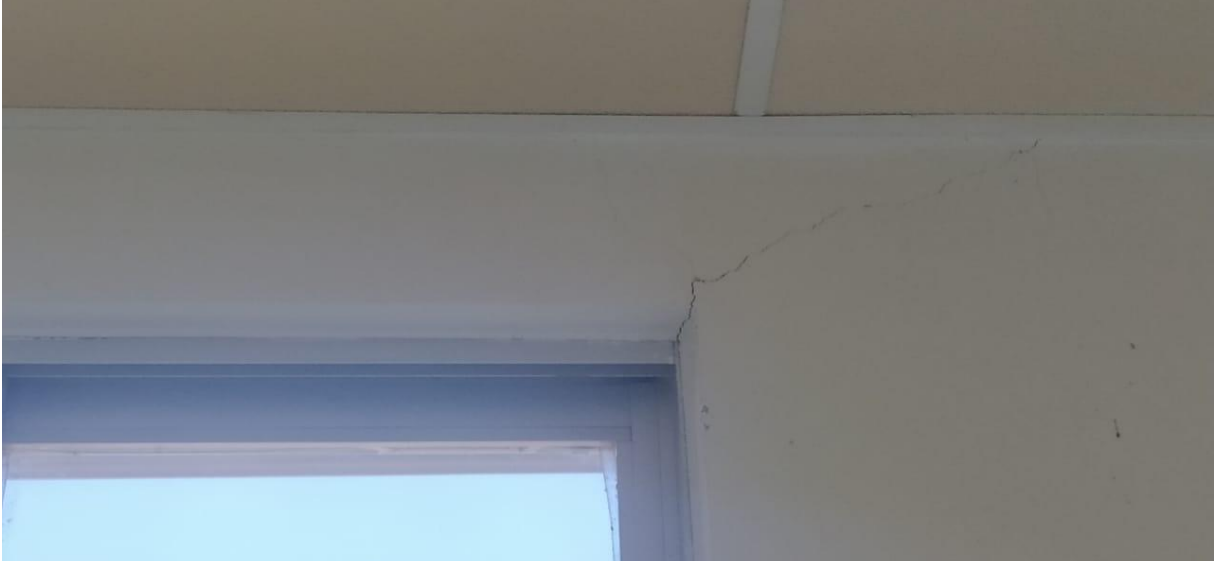
Figura 42 – Trincas entre juntas de dilatação no banheiro próximo ao Gabinete de Estudo Individual
