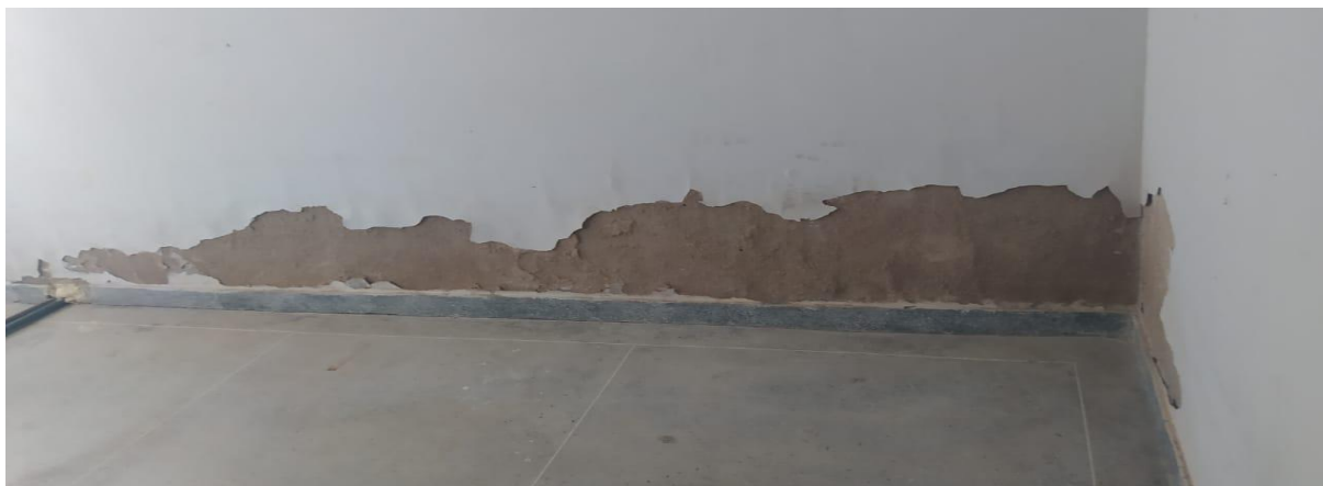
Figura 58 – Descolamento em placas na Casa de Máquinas
