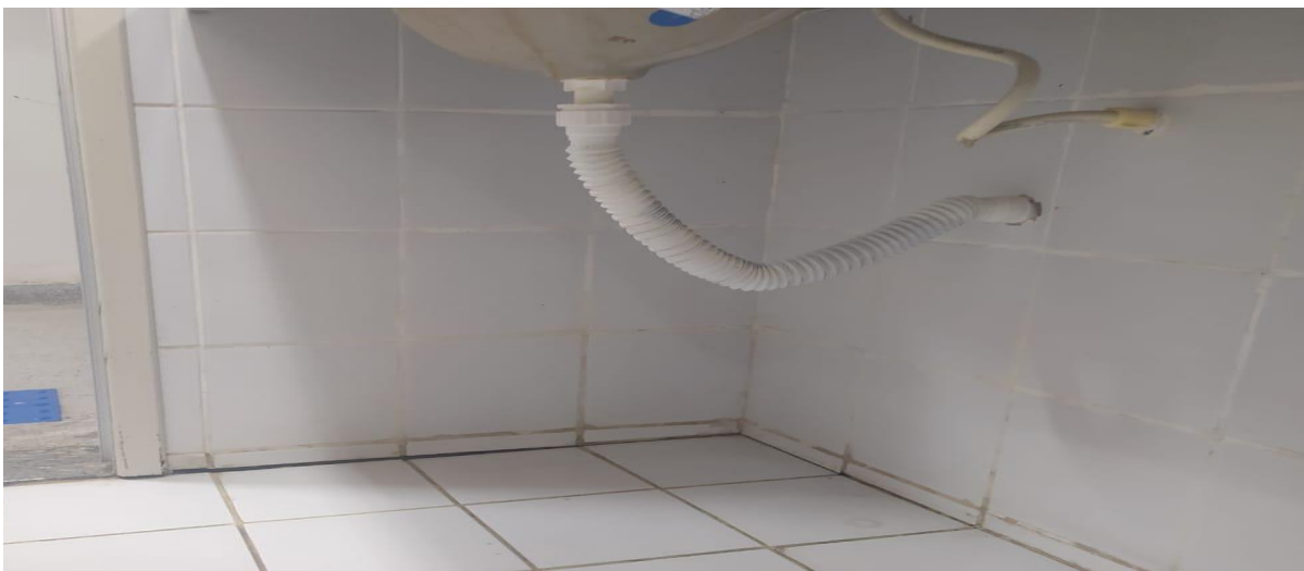
Figura 13 – Fissura de Deslizamento nos banheiros femininos e masculinos para alunos
