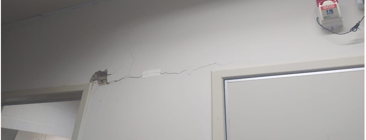
Figura 46 – Fissuras entre duas esquadrias no Hall de Circulação de Serviço
