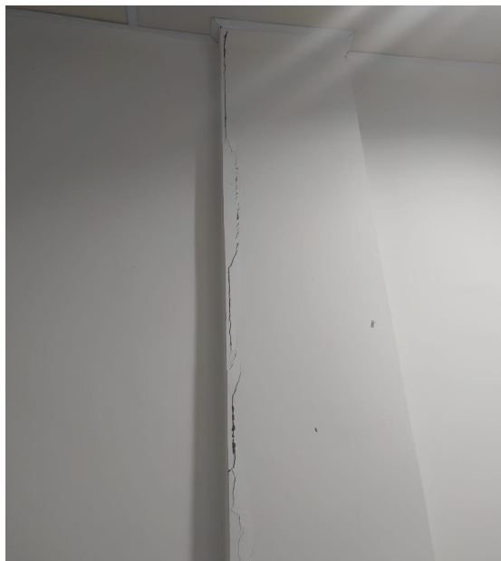
Figura 60 – Fissura vertical em pilar interno na área de Circulação de Serviço
