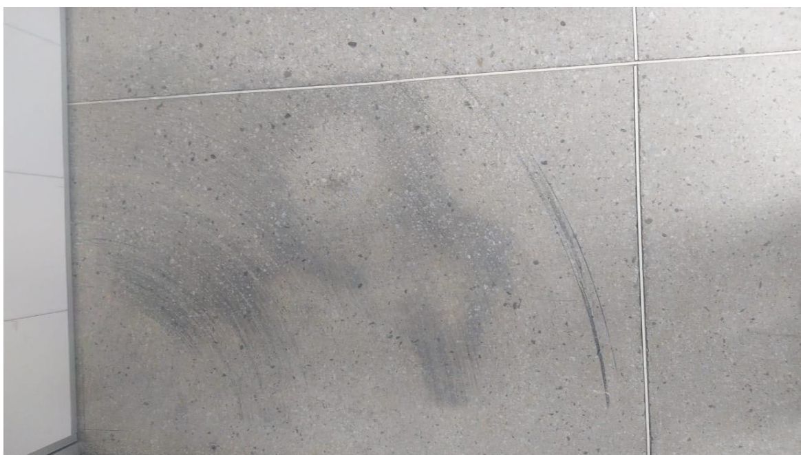
Figura 32 – Desgaste Superficial na Sala da Coordenação
