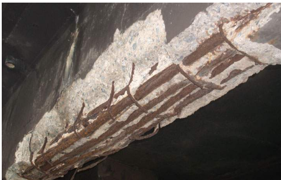
Figura 4 - Viga com carbonatação e corrosão do concreto
