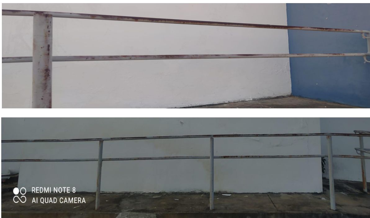
Figura 66 – Corrosão de Corrimãos da parte externa do edifício
