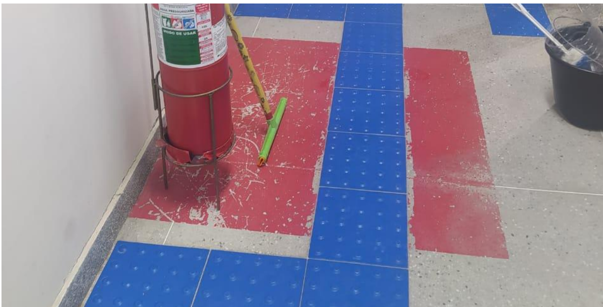
Figura 28 – Desagregação de pintura no Hall de Circulação de Serviço
