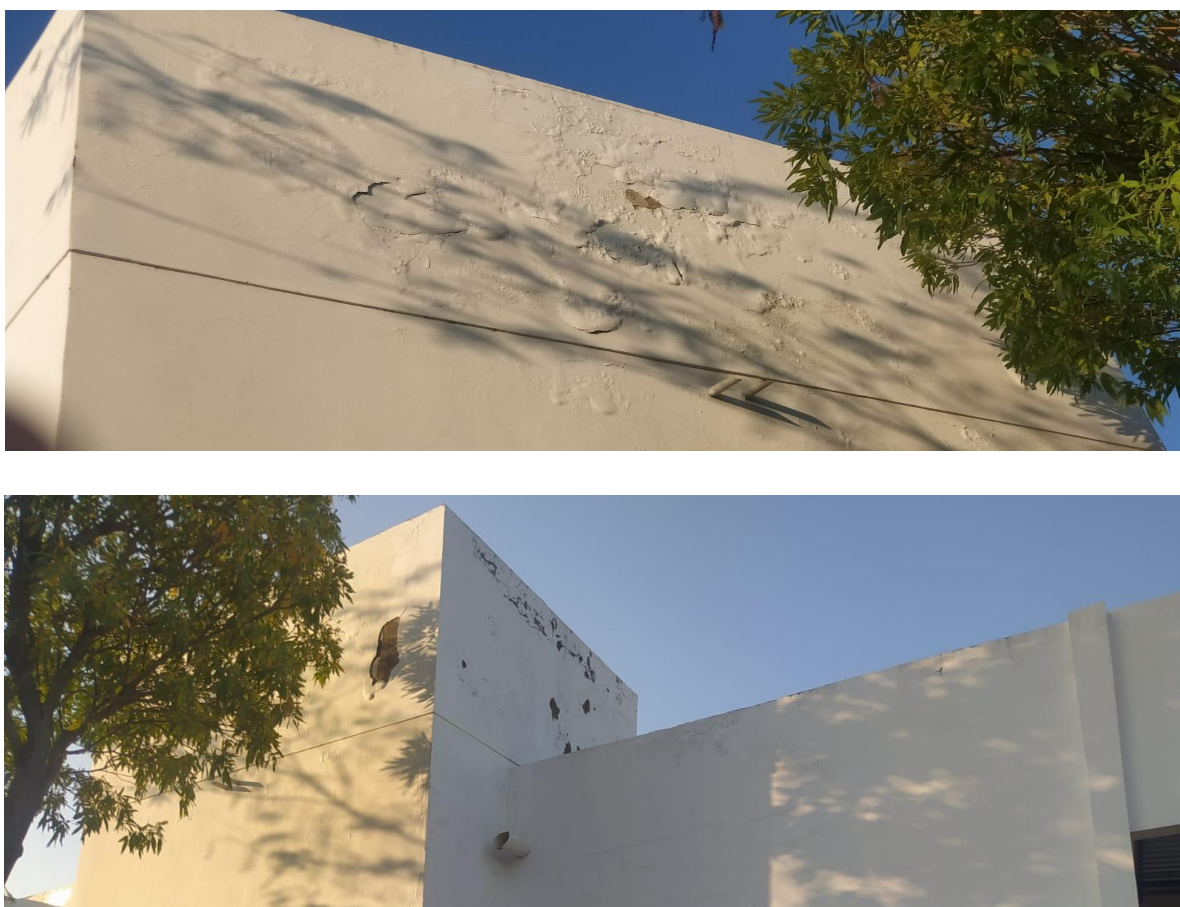
Figura 55 – Empolamento e Descolamento em forma de bolhas, e deslocamento em placas na parte externa do prédio da Biblioteca
