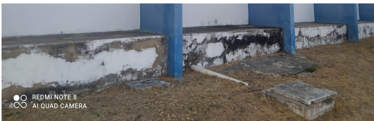
Figura 17 – Infiltração por capilaridade na parte externa do prédio
