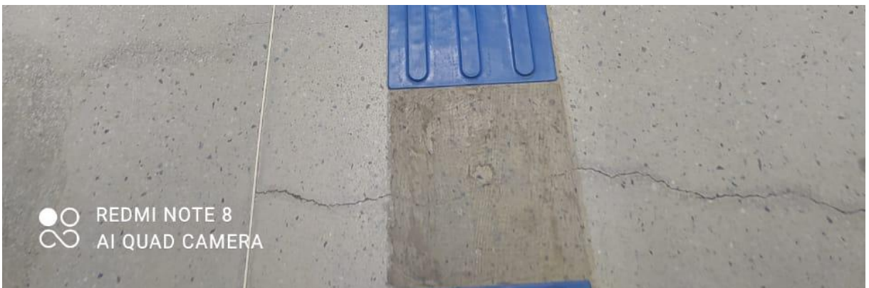
Figura 23 – Fissuras e Trincas no Hall de Circulação de Serviço dos usuários
