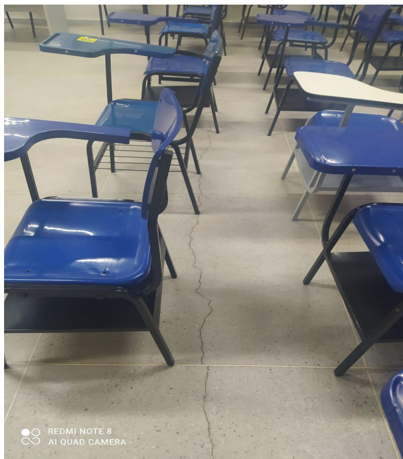
Figura 24 – Fissuras e Trincas na Multiteca
