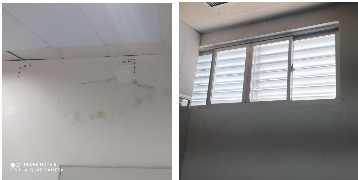
Figura 51 – Manchas de Umidade por infiltração de água pluvial no Acervo Geral
