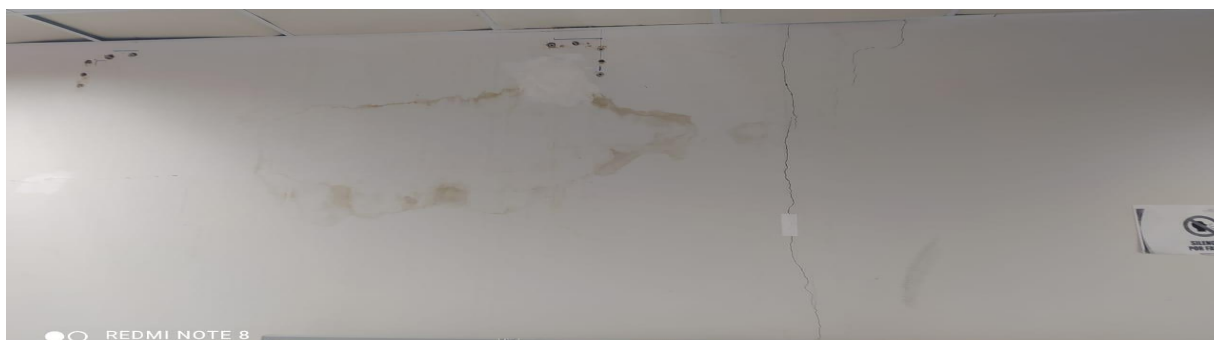
Figura 35 – Fissura vertical no Acervo Geral
