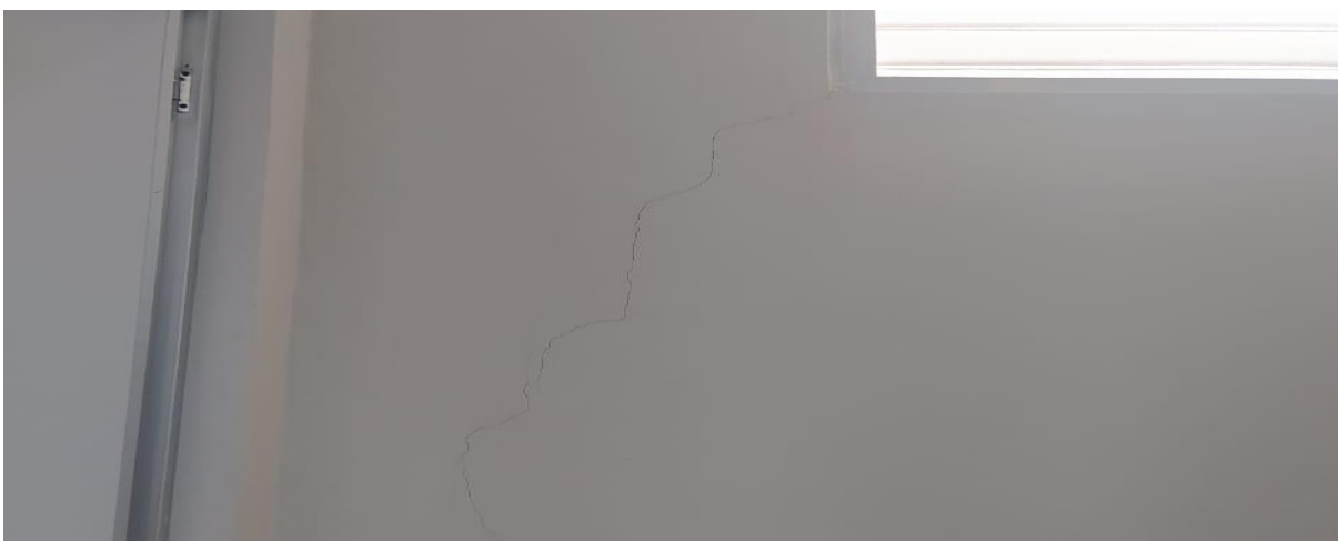
Figura 41 – Fissura geométrica ativa progressiva no canto inferior da esquadria no Gabinete de Salas de Estudos em Grupo
