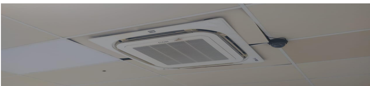
Figura 68 – Sobrepeso em uma das placas modulares de PVC devido ao encaixe de um ar condicionado de teto no Espaço Digital
