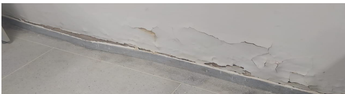
Figura 57 – Descolamento de revestimentos de rodapé no Espaço Digital
