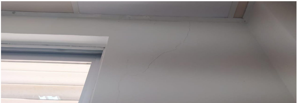
Figura 45 – Trincas superior saindo da esquadria em direção ao teto no Gabinete de Estudos em Grupo
