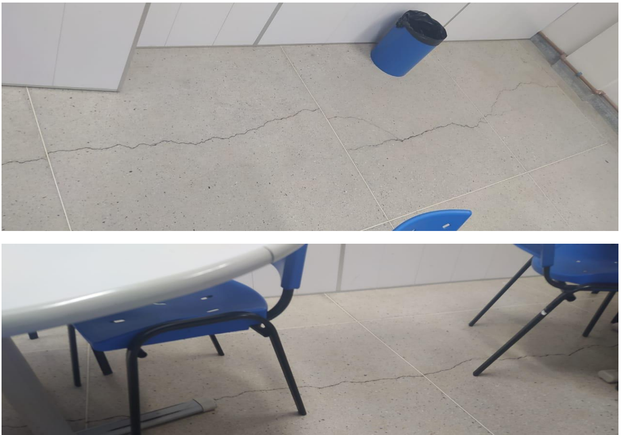
Figura 21 – Fissuras e Trincas no Gabinete de Estudos de sala em grupo
