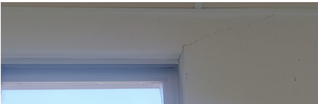
Figura 37 – Fissura geométrica no canto superior da esquadria nos banheiros dos usuários
